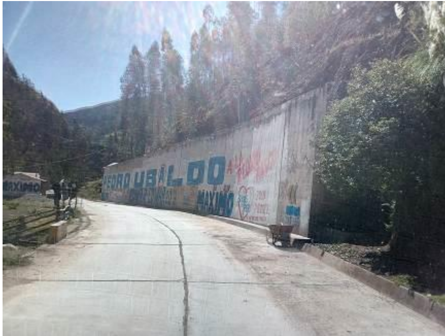
Foto No 16 Deslizamiento de suelo retenido debido a un muro de contención – Chacra Colorada
