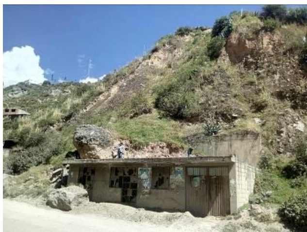
Foto No 1 Evidencia de materiales caídos por fuerte precipitación, expuesta sobre la carretera central - Huariaca
