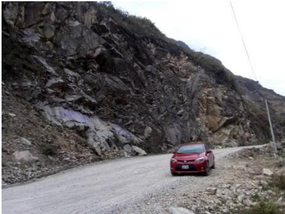
Foto No 37 Bloques de rocas inestable en el talud de la carretera a Paucartambo.
