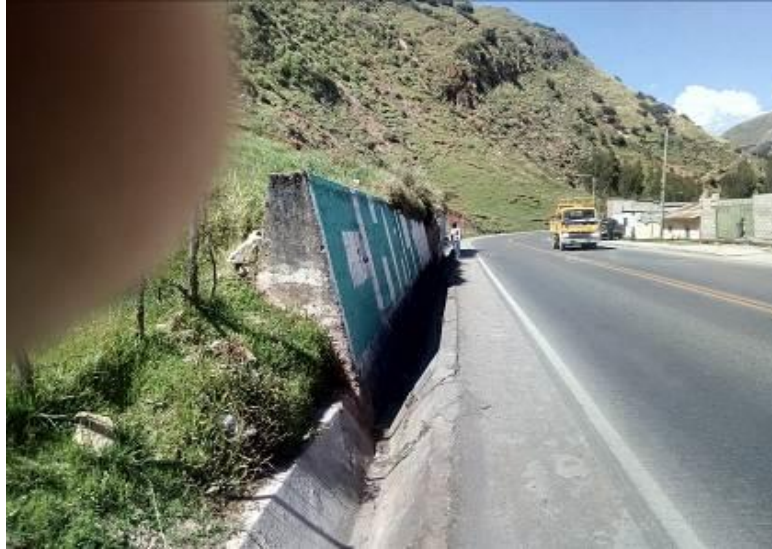
Foto No 13 Evidencia del desequilibrio del muro de contención debido a presión deslizando suelo en el talud de carretera – Yanapampa.
