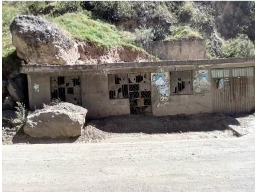
Foto No 37 Vivienda destruida por caída de rocas, entrada de Huariaca.
