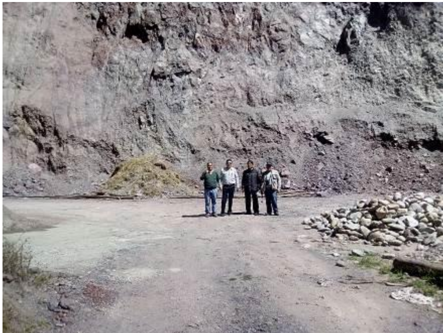
Foto No 31 Amenaza de caída de roca, sobrepuesta sobre un material molasico inestable, zona al norte de Huariaca – Ruta a Pallanchacra.
