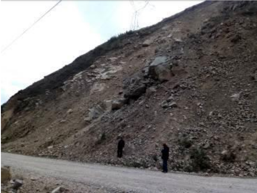
Foto No 19 Deslizamiento de suelo superficial – Paucartambo
