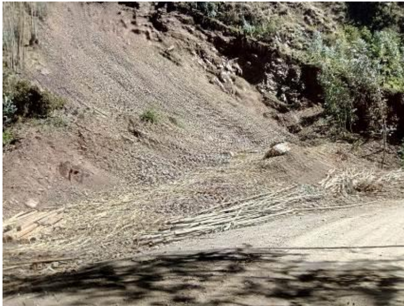
Foto No 25 Amenaza de terrenos inestable zona Chacra Colorada – Ruta Pallanchacra, producto de una deforestación por el hombre
