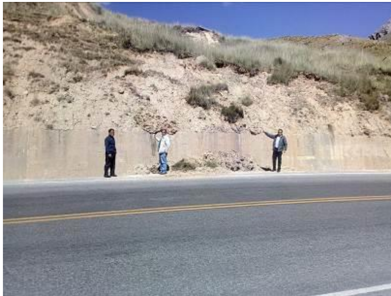
Foto No 14 Suelo deslizamiento superficial carretera central – Palca
