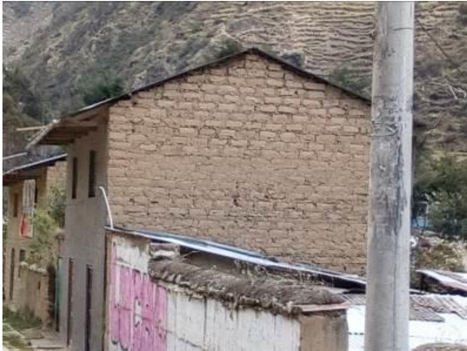
Foto No 35 Construcción de vivienda con material inadecuado para la zona, con cierto grado de sismicidad. – Paucartambo
