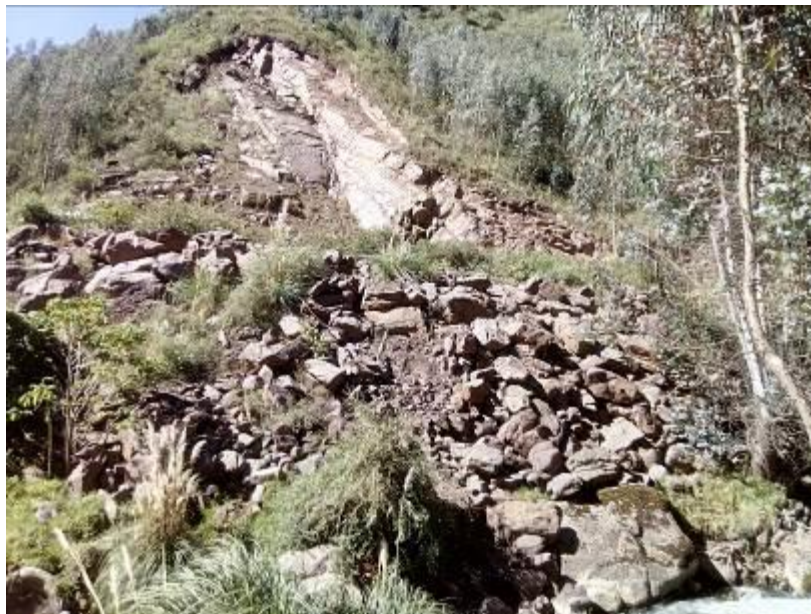
Foto No 32 Área peligro medio, producto de alteración, fracturación inicial (cerradas) Fundición – Pallanchacra
