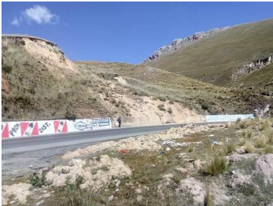
Foto No 40 Deslizamiento de suelo, zona de Palca.
