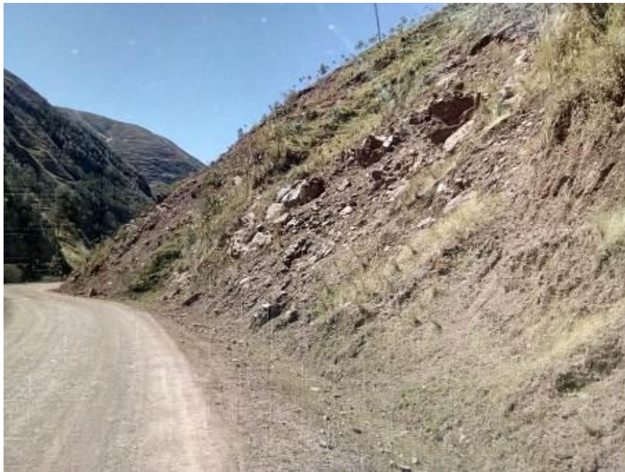
Foto No 18 Deslizamiento de suelo superficial – Junipalca
