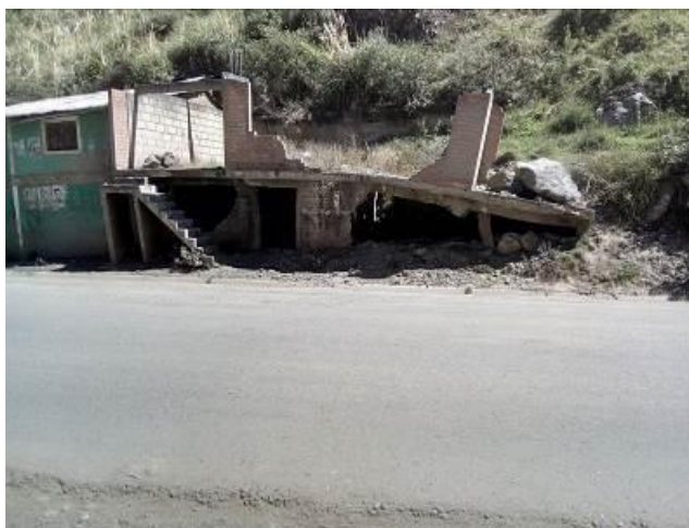
Foto No 2 Vivienda destruida por fuerte precipitación - riesgo hidrogeológico - carretera central - Huariaca
