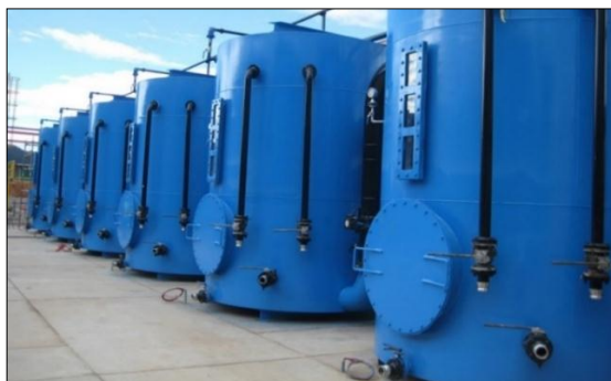
Figura N° 2.4: Columnas de adsorción – La Arena S.A.
