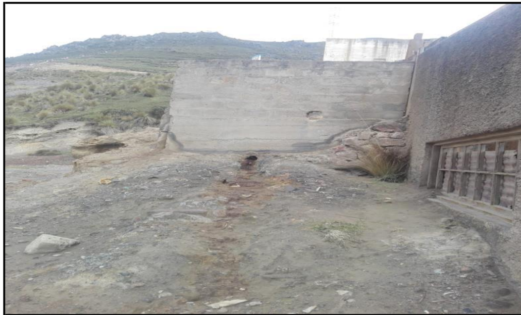
Fotografía N° 03: PASIVO AMBIENTAL DE INFRAESTRUCTURA DE PLANTA GENERANDO DRENAJE ACIDO
