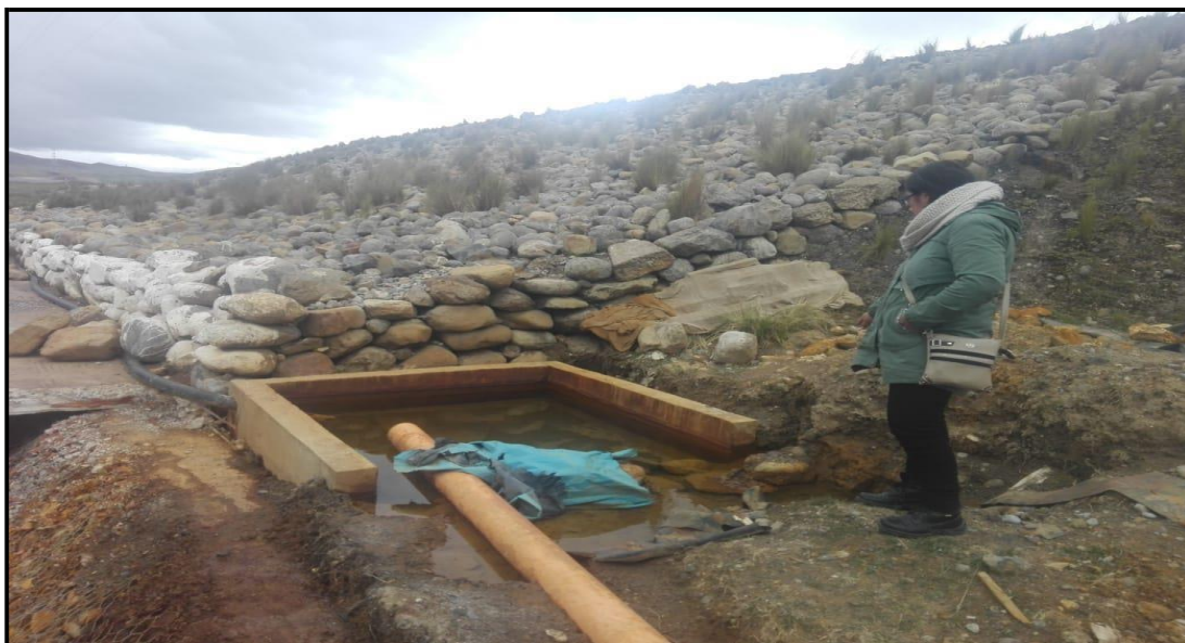
IMAGEN N° 07: AFECTACIÓN DEL SUELO Y AGUA POR AGUAS ACIDAS EN QUIULACOCHA
