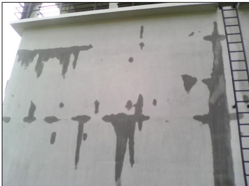
Ilustración 17: filtración a causa de fisuras.
