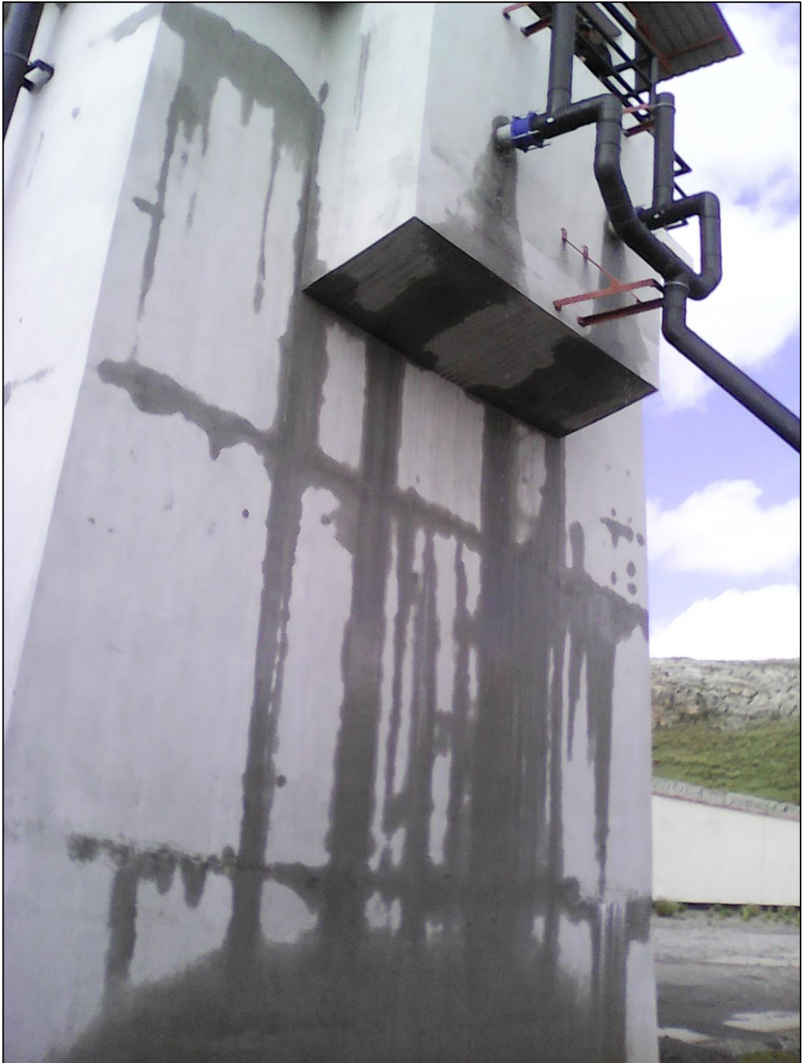
Evidencia de fisuras y la filtración de agua en tanques de la planta de tratamiento de aguas residuales del centro penitenciario.
