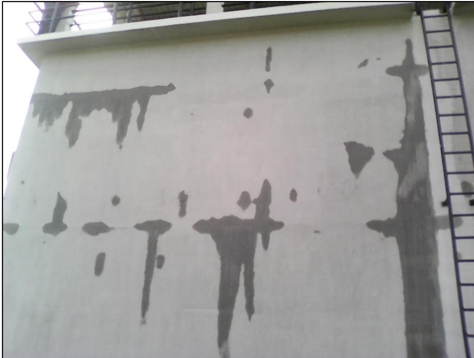
Evidencia de fisuras y la filtración de agua en tanques de la planta de tratamiento de aguas residuales del centro penitenciario.
