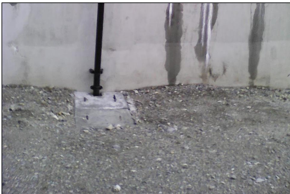
Evidencia de fisuras y la filtración de agua en tanques de la planta de tratamiento de aguas residuales del centro penitenciario.
