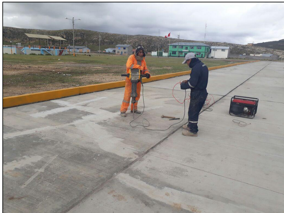
Ilustración 18: Paño con fisura del pavimento en el centro Poblado de Cochamarca
