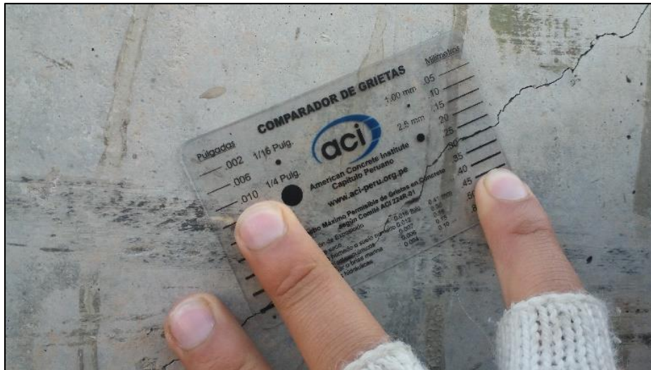
Ilustración 15: Medición de Fisura
