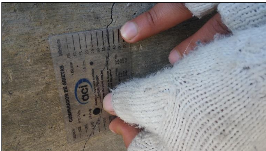
Ilustración 14: Medicion de Fisura
