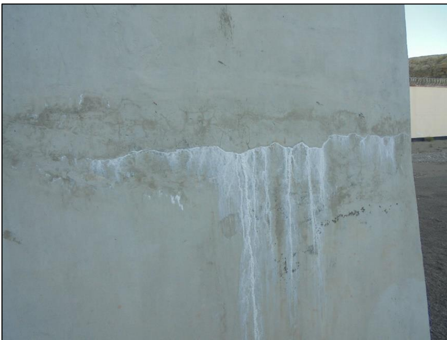
Evidencia del tratamiento de fisuras en tanques de la planta de tratamiento de aguas residuales del centro penitenciario.
