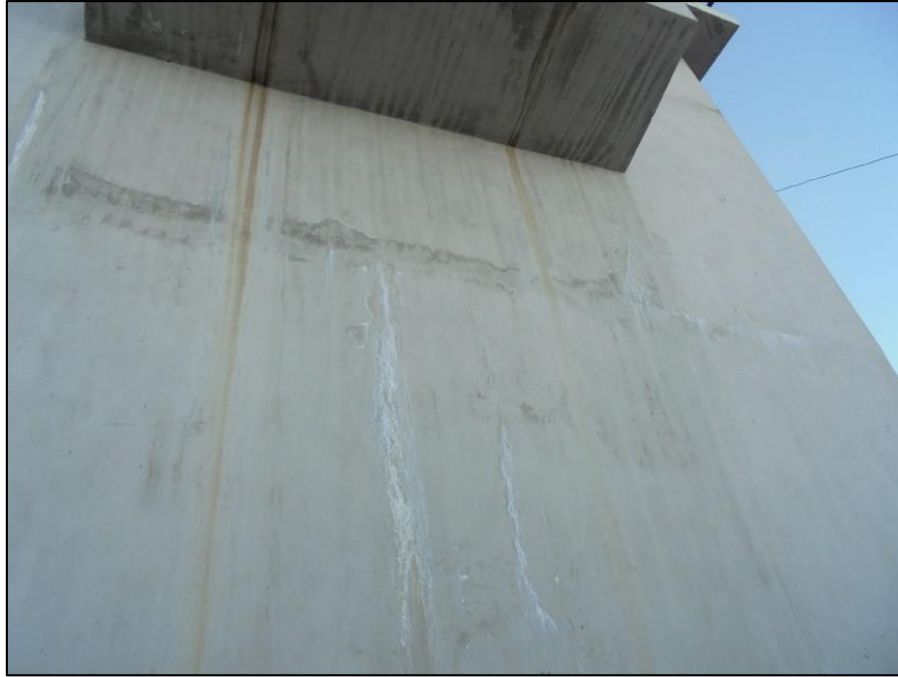
Evidencia del tratamiento de fisuras en tanques de la planta de tratamiento de aguas residuales del centro penitenciario.
