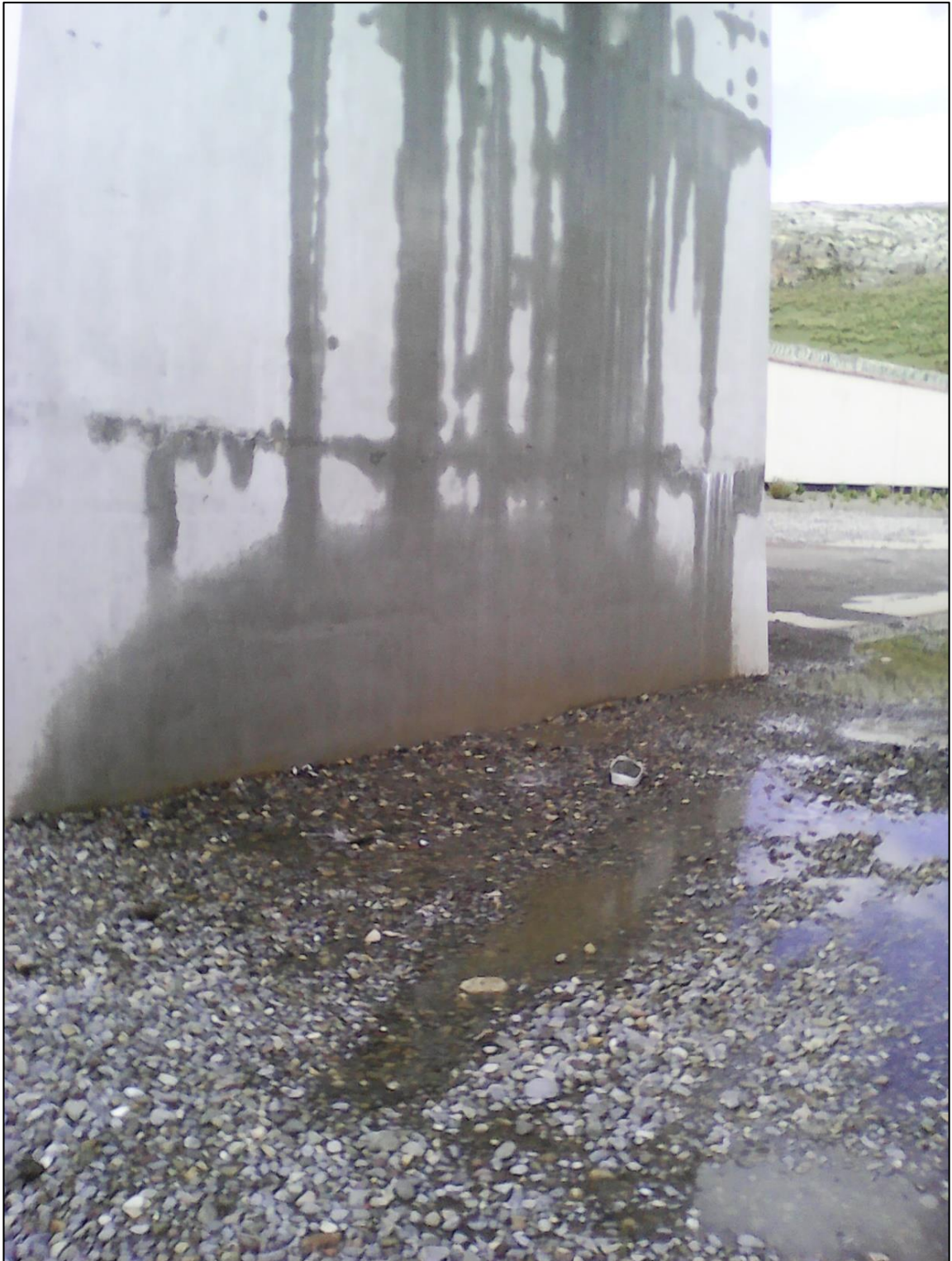
Evidencia de fisuras y la filtración de agua en tanques de la planta de tratamiento de aguas residuales del centro penitenciario.
