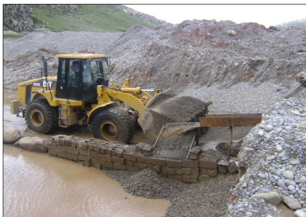
Ilustración 11. Extracción de hormigón de segundo lavado de cant. Sacrafamilia mediante maquinaria pesada Fuente: Propio
