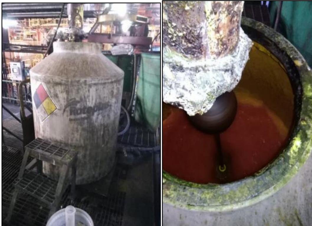
Tanques de preparación del RCS
