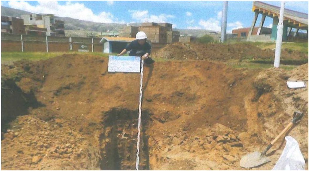
Fotografía 10: vista de la calicata N° 16 con profundidad de 6 m. UTM 478112 m. E y 8665480 m. N
