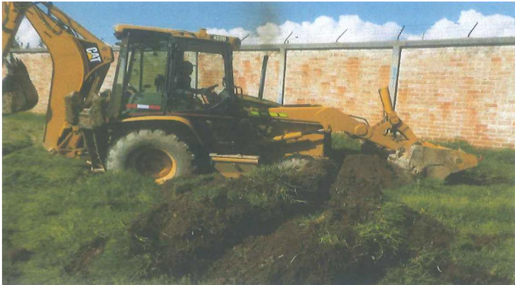
Fotografía 1: Vista de la calicata N° 01 con profundidad de 6 m. UTM 477 971 m. E y 8 665 323 m. N.
