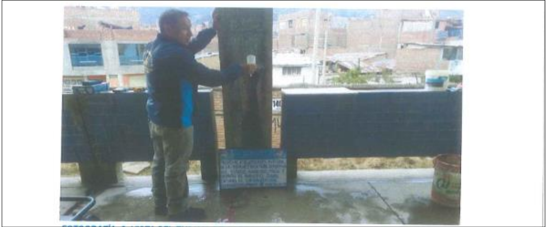
FOTOGRAFIA 3: Vista del ensayo de carbonatación de la diamantina columna D2-M1, tribuna oriente.
