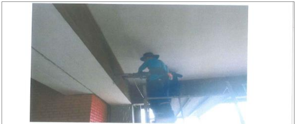
FOTOGRAFIA 12: Vista de la extracción y carbonatación de diamantina viga D9-M1, tribuna occidental para el proyecto.
