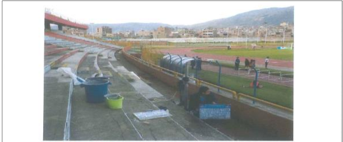
FOTOGRAFIA 9: Vista panorámica de la extracción y carbonatación de diamantina losa D22-M2, tribuna occidental para el proyecto.
