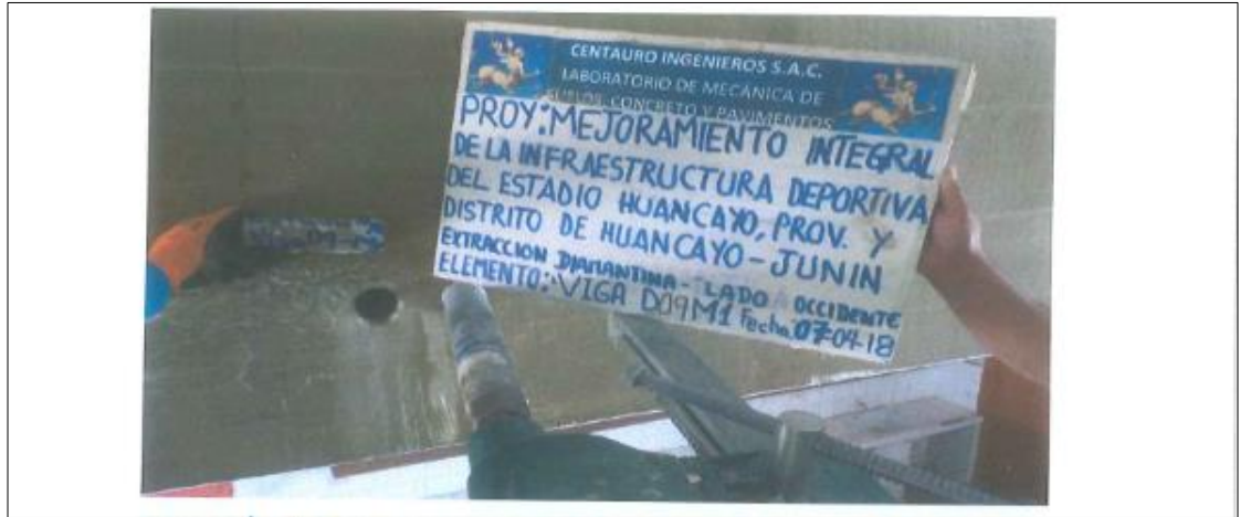
FOTOGRAFIA 11: Vista de la extracción de diamantina viga D9-M1, tribuna occidental para el proyecto.
