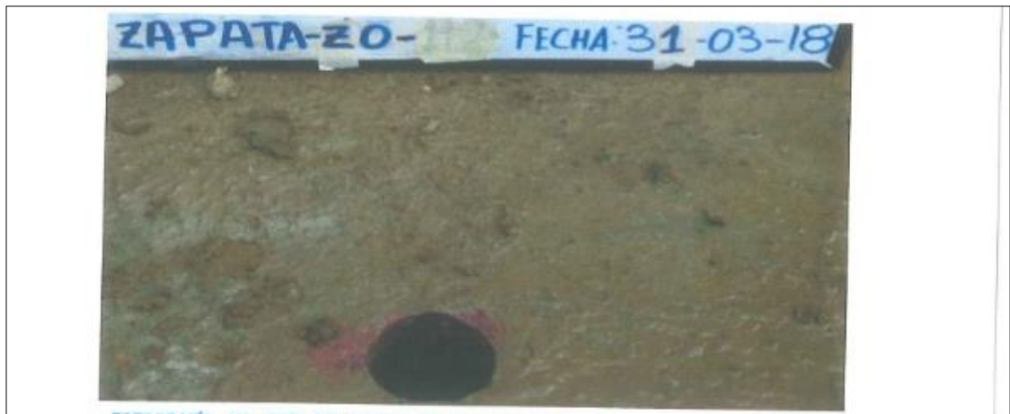
FOTOGRAFIA 6: Vista de ensayo de carbonatación de la diamantina Zapata M2 tribuna Occidental.
