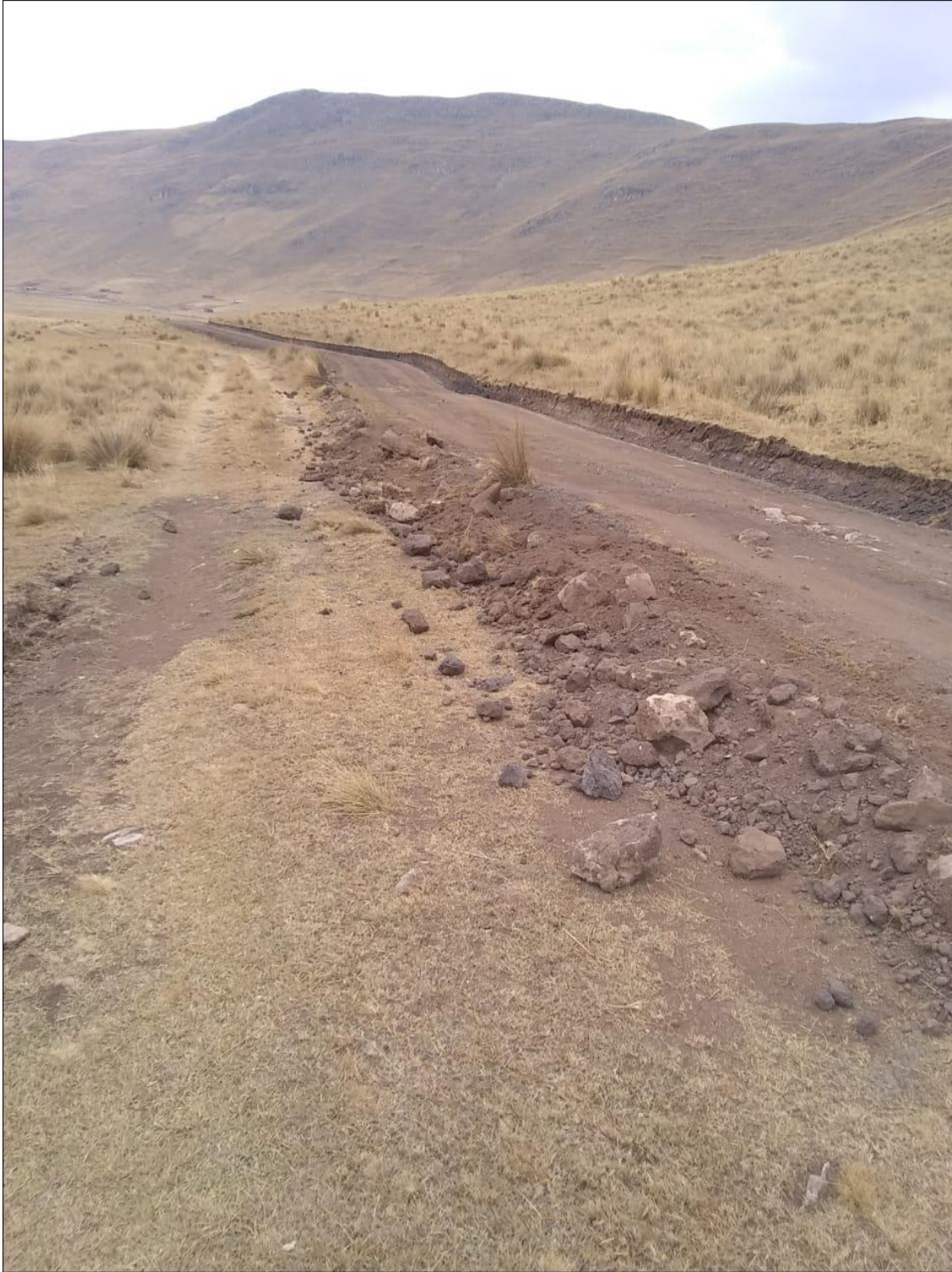
FOTOGRAFÍA N°04: SE OBSERVA LA LIMEPIZA Y TRAZO EMPÍRICO DE LA TROCHA SIN AFIRMAR
