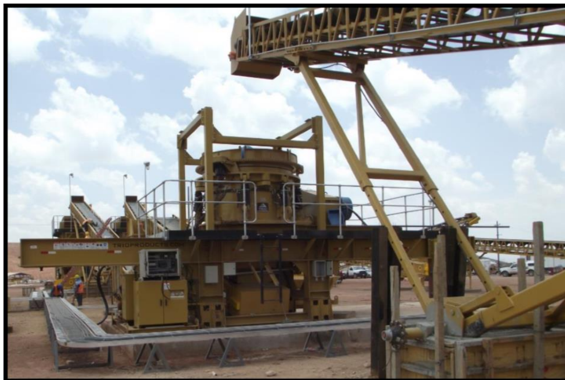
Figura 4 Disposición la chancadora terciaria Trio TCHS84 SH/Fine Liner
