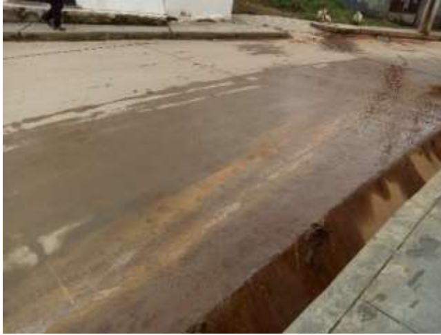
Fisuras en veredas
