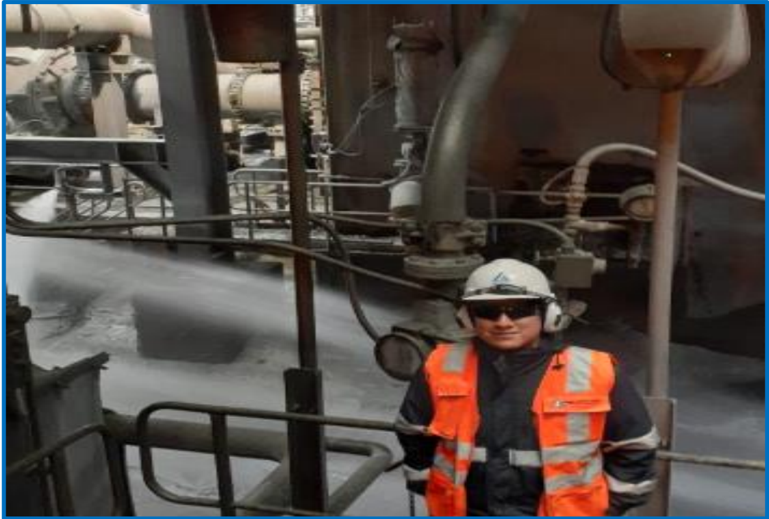
Anexo 20 – Bomba Warman de alimentación a nido de hidrociclones.
