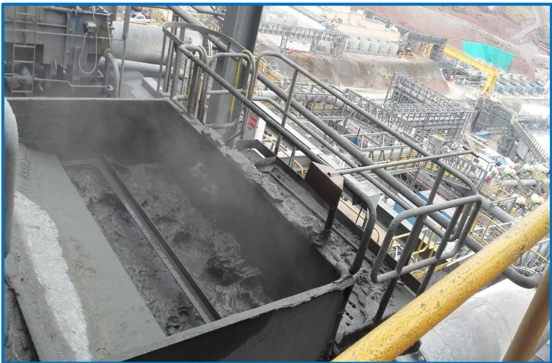
Anexo 15 – Cajón del overflow de alimentación a celdas Ro-Bulk.
