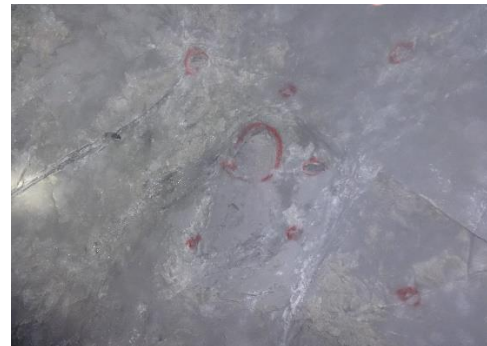
Figura: 59 Falta de simetria y control de paralelismo en el arranque.
