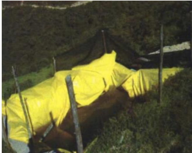
Figura 15 - Poza de sedimentación impermeabilizada y completamente cercada
