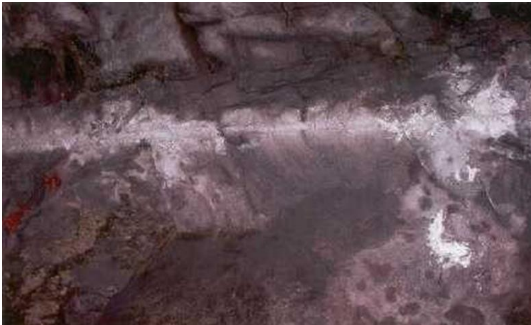
Fotografía N° 2.1: Daño que sufre la pared del taladro y su entorno
