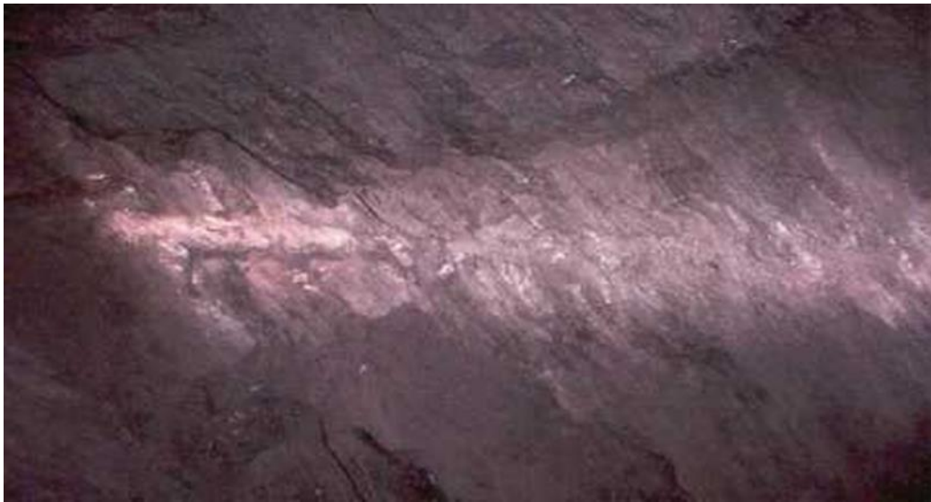
Fotografía N° 2.3: Tramo de mayor daño en la pared de la galería
