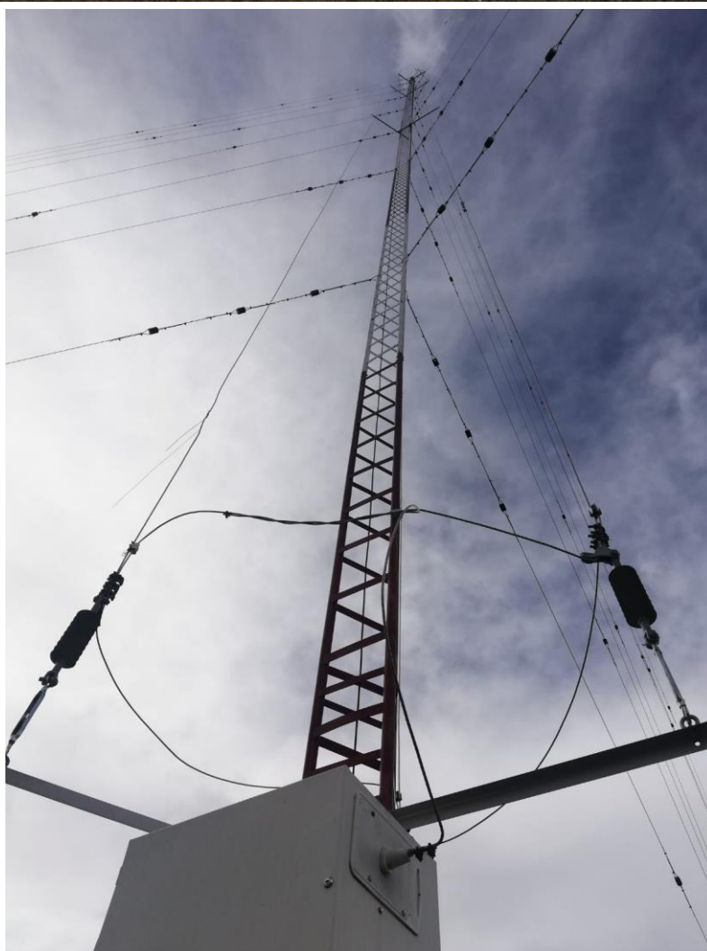
Figura 7: Antena monopolo de tres vías de radio San Juan. Nótese los aisladores que evitan que la radiofrecuencia tenga conducción a la estructura metálica. La torre es sólo el soporte de las antenas. En la base la caja de sintonía.
