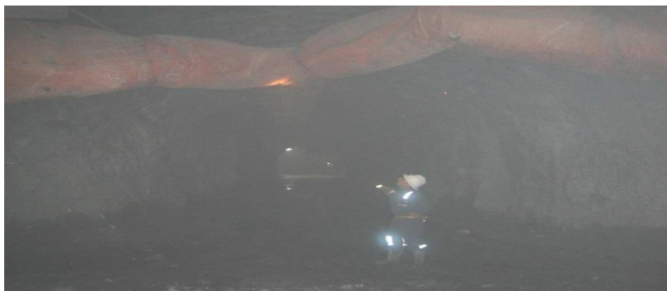
Ilustración 12, Mangas de ventilación que proporcionan aire fresco a los frentes de trabajo.
