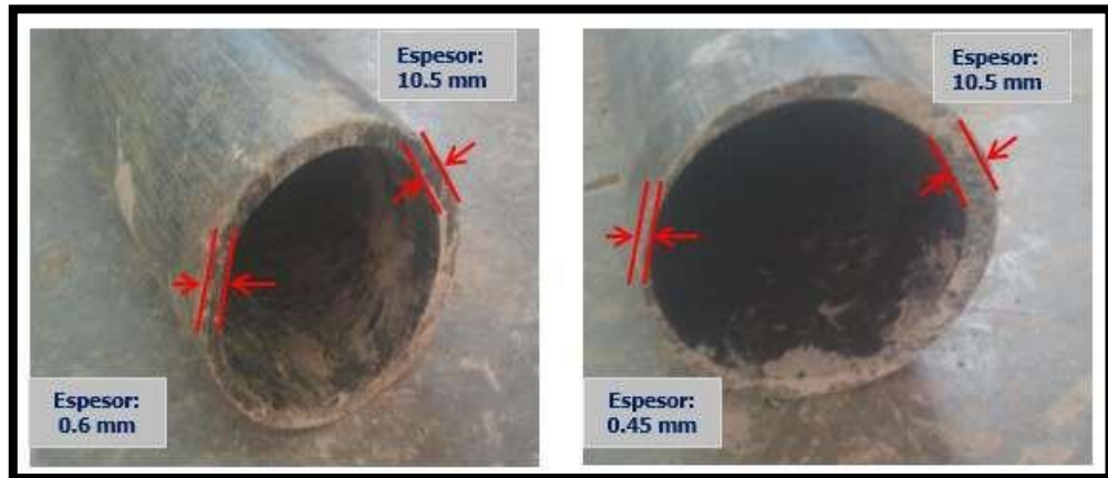
Gráfico N° 04. Desgaste de espesores de tubería de relleno línea 04
