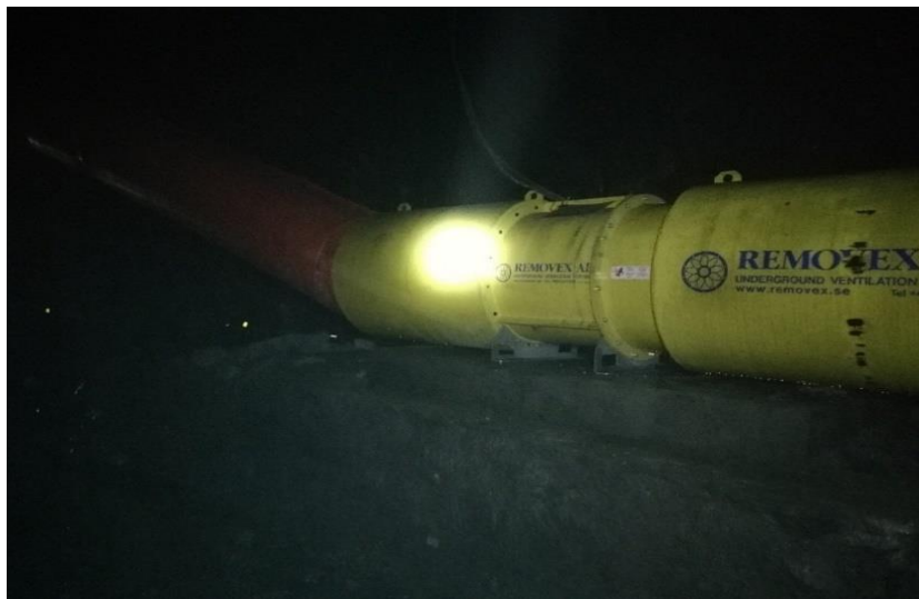
figura N° 20. Sistema de ventilación
