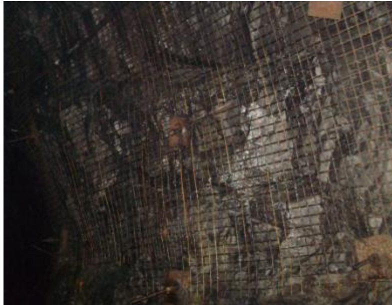
figura N° 28. Malla electro soldada instalada en Berlín
