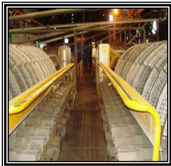
Fotografía 1.11. Sección de filtrado, actualmente ya se cuenta con un filtro Automatizado
