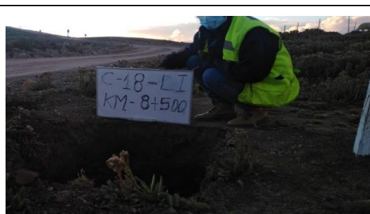
Fotografía N°C-18b: Se observa la Calicata C-18, ubicada al lado izquierdo de la vía.
