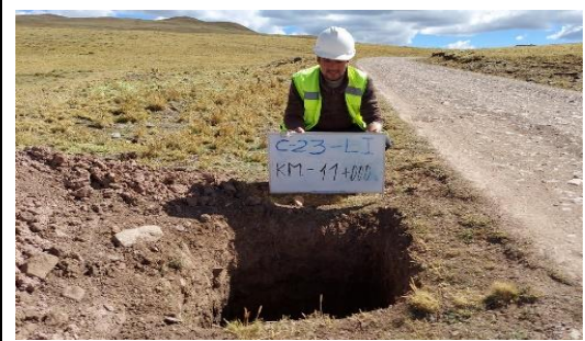
Fotografía N°C-23b: Se observa la Calicata C-23, ubicada al lado izquierdo de la vía.
