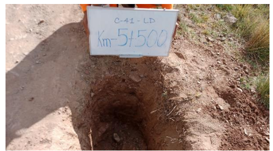
Fotografía N°C-41b: Se observa la Calicata C-41, ubicada al lado derecho de la vía, encontrando roca a la profundidad de 0.85 m.
