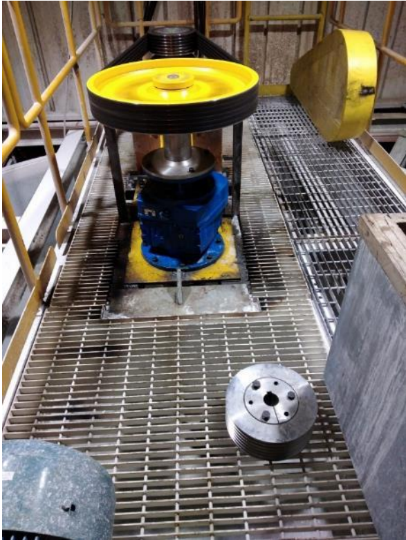
Agitador del tanque de dosificación de lechad de cal
