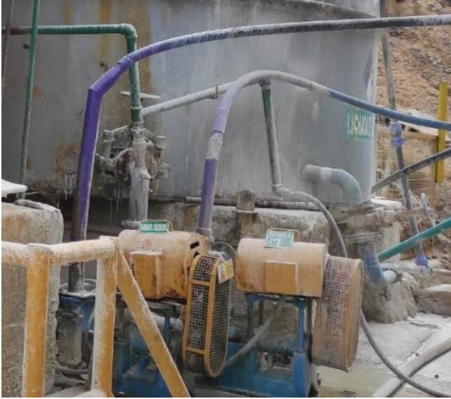
Bomba dosificadora de lechada de ca
