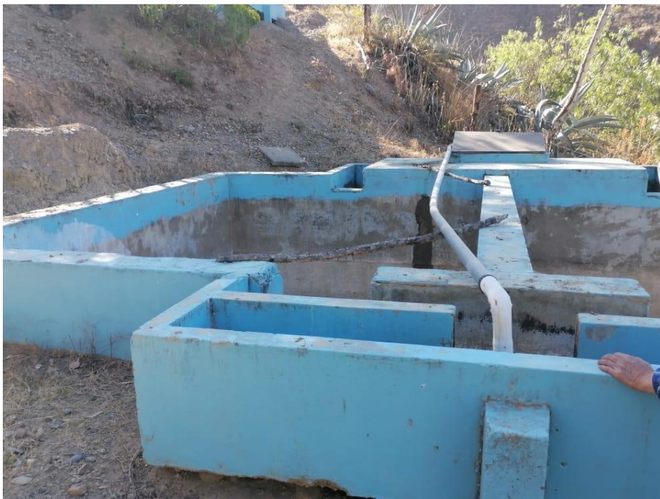
Foto 5 Canal de precipitación del agua
