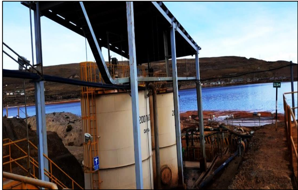
Figura N° 24: Tubería para traslado para la lechada de cal hacia el tanque 1 de neutralización 200 TK-0-2.
