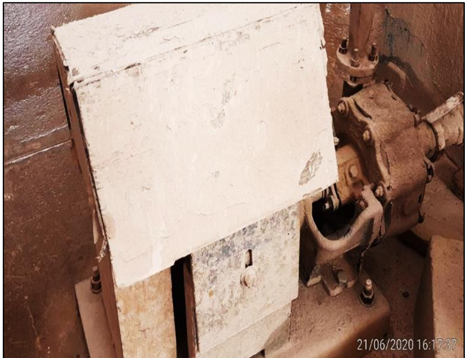
Figura N° 19: Bomba auxiliar de la solución de lechada de cal
