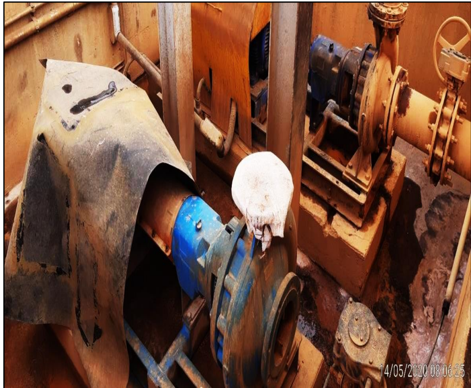
Figura N° 36: Bomba 2 del sistema de bombeo de aguas neutralizadas.
