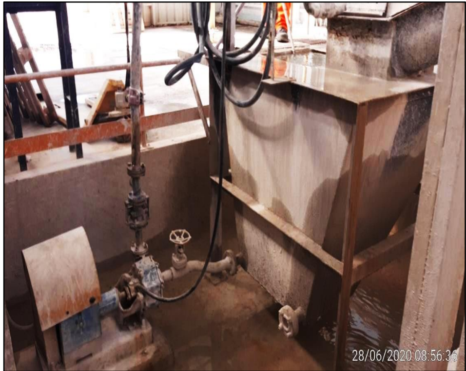
Figura N° 16: Cajón principal de la solución de lechada de cal
