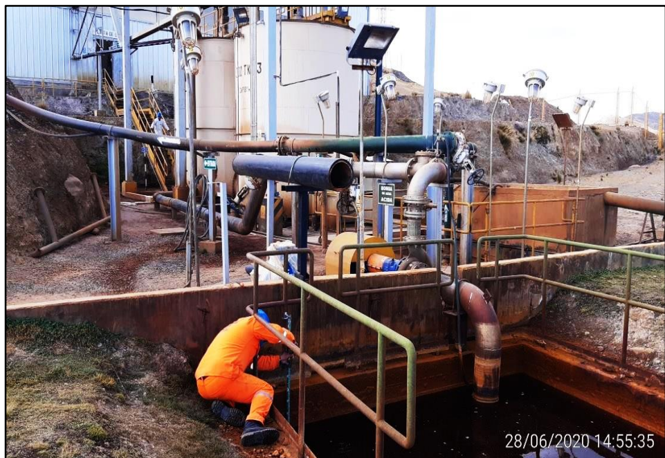
Figura N° 37: Puesta de la regleta, para la medición del nivel de agua ácida, en el lugar del punto de bombeo de agua ácida hacia la planta de neutralización.
