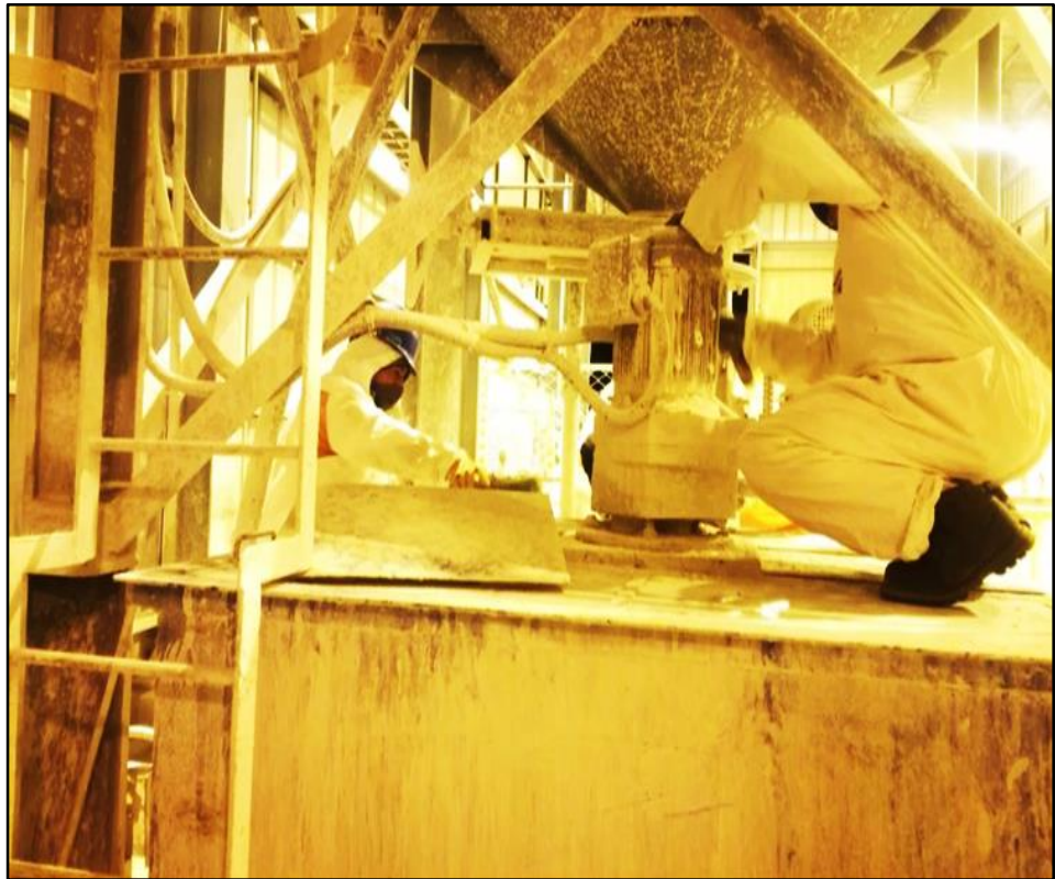
Figura N° 18: Caja auxiliar de la solución de lechada de cal
