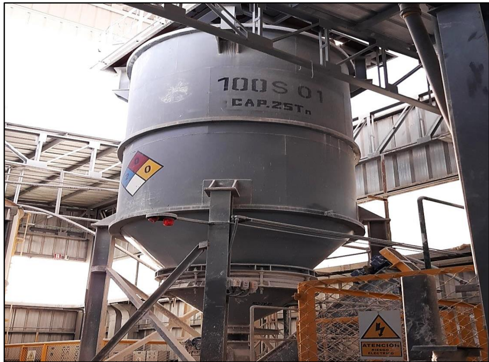
Figura N° 12: Silo de almacenamiento de cal hidratada de 25 TM de capacidad.
