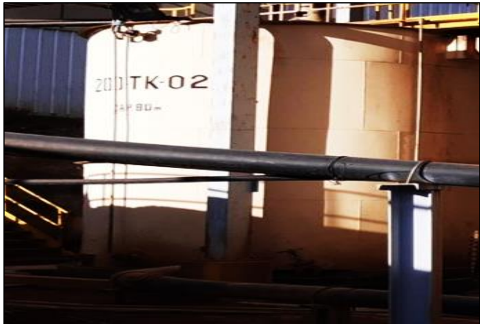
Figura N° 25: Tanque neutralizador 200-TK-02: Tanque 1 de neutralización de 80 m 3 , aquí se lleva a cabo el proceso de neutralización entre el agua ácida y el hidróxido de calcio, catalizados con aireación y agitación.
