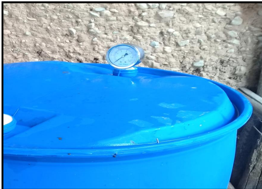
Imagen N° 3: Instalación de Manómetro
