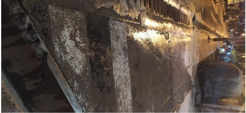
Figura 22. Estado de señal horizontal en la Av. La Cultura – Señal de Pase Peatonal
