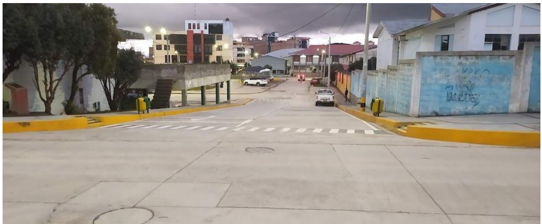
Figura 24. Estado de señal horizontal en la intersección entre Av. Los Incas y Jr. Calle Janampa – Señal de Pase Peatonal.
