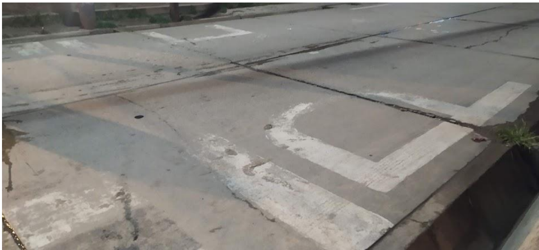
Figura 21. Estado de señal horizontal en la Av. La Cultura – Señal de PARE.
