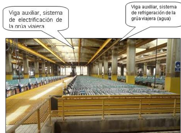
Figura 4: Vista panorámica del ingreso de la grúa viajera
