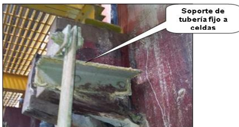
Figura 20: Soporte fijo para la tubería
