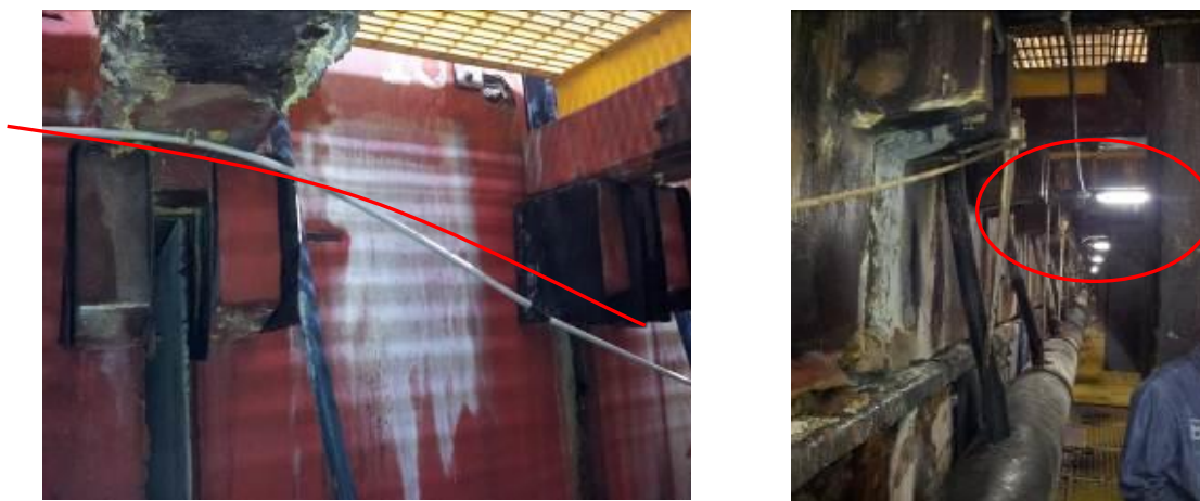
Figura 21: Sistema de cableado eléctricos
