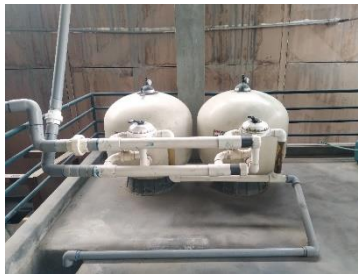
FOTO 32: Filtros de arena
