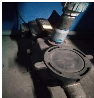
FOTO 10: Electrobomba de agua
