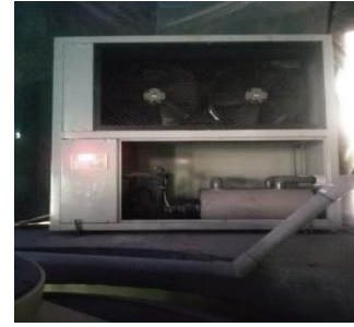
FOTO 27: Chiller ya instalado
