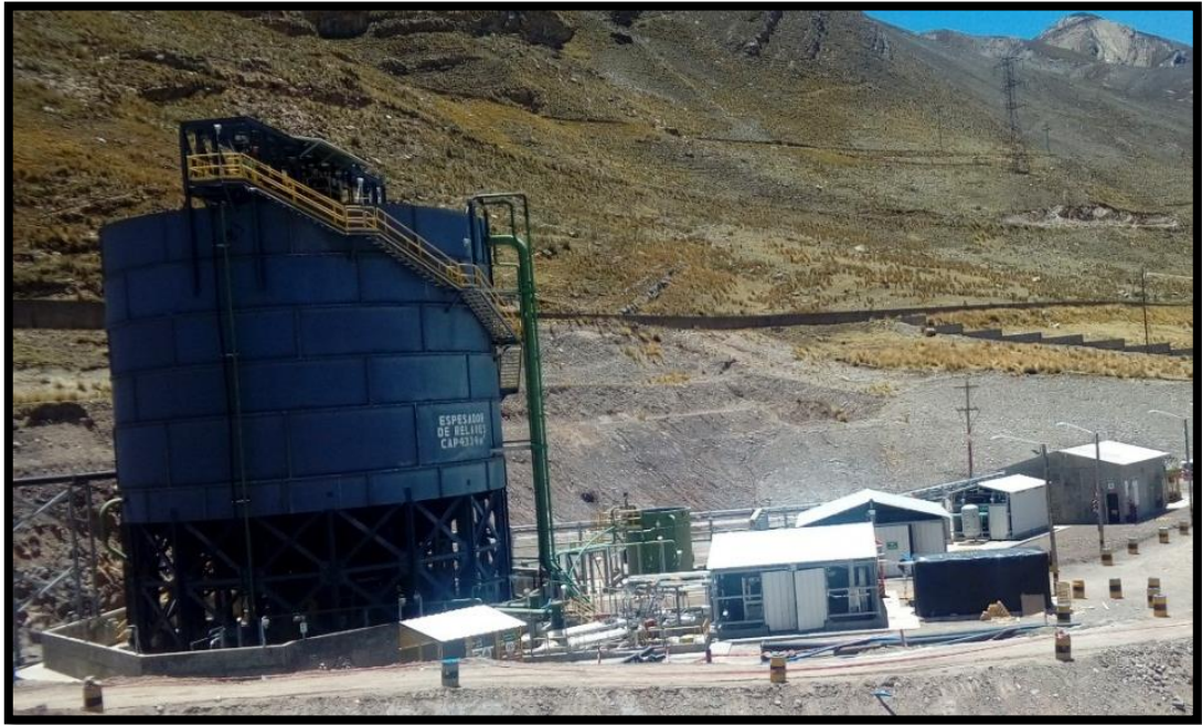
Foto 1. Planta de Espesador de relave de Cono Profundo (DCT) – Relavera Rumichaca
