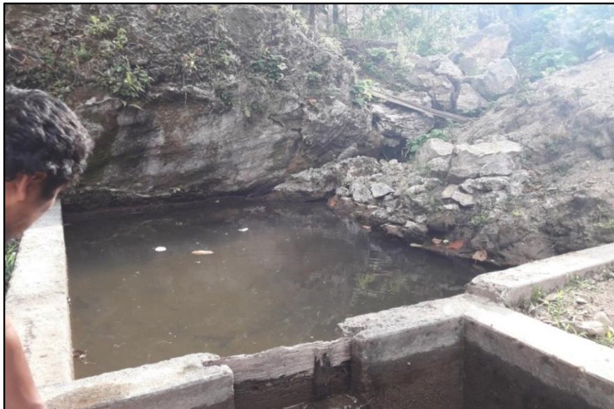
Anexo N° 2a. Estado de la infraestructura del punto de captación (Miraflores).
