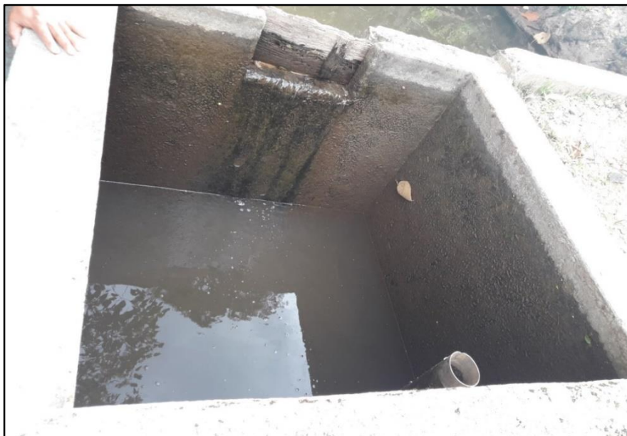
Anexo N° 2b. Estado de la infraestructura de la cámara colectora de la captación denominada Miraflores.
