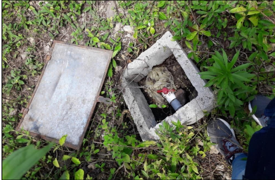
Anexo N° 2m. Estado de las válvulas de purga del sistema de agua de
