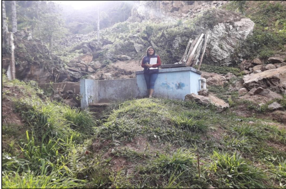
Anexo N° 2c. Infraestructura completa de la captación de agua (Miraflores).
