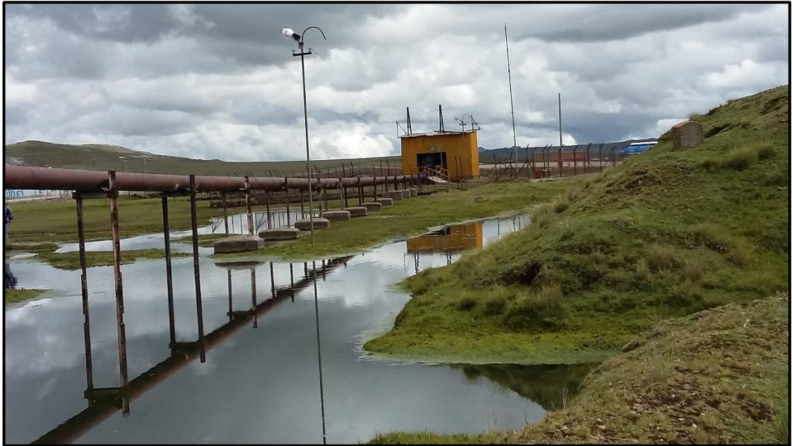
Imagen 2. Caseta de bombeo desde el Punto de captación - Río San Juan - Yurajhuanca
