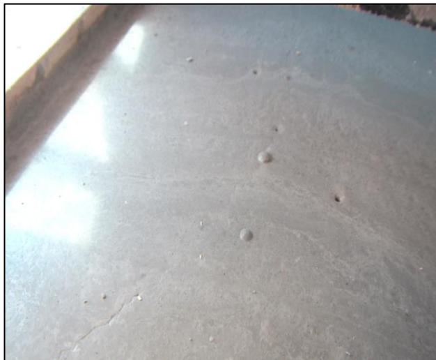
Figura N° 50 GC1 y GC2 agujeros en el mortero en estado inicial de fraguado.
