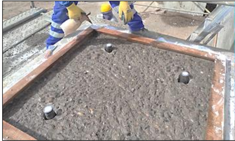
Figura N° 64 GE saturación de la superficie.
