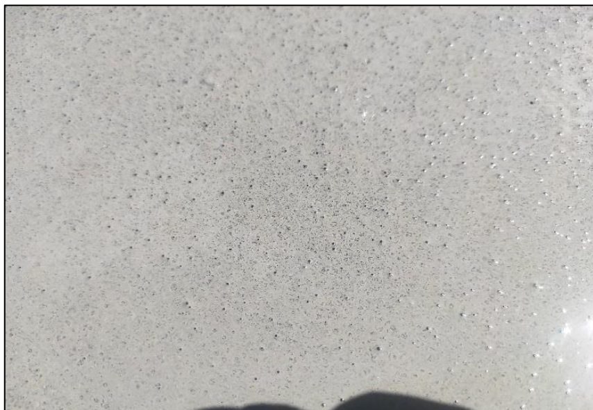
Figura N° 43 Burbujas de aire atrapado en la superficie de la mezcla
