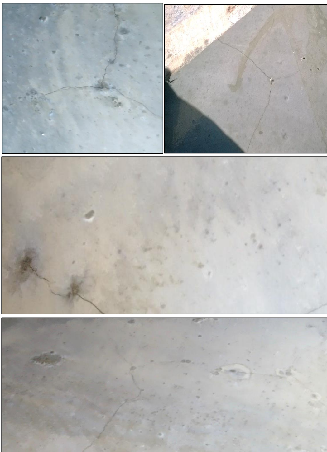
Figura N° 46 GC1 fisuras en el mortero durante el fraguado.
