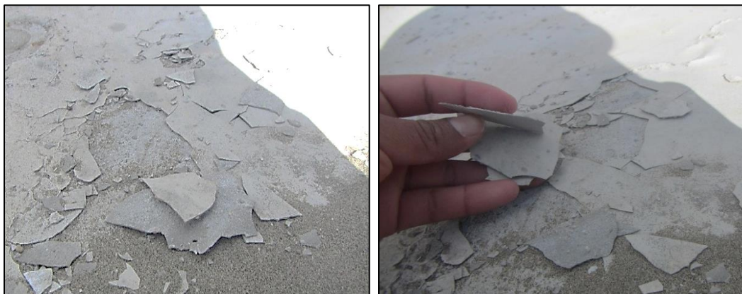
Figura N° 57 GC1 descascaramiento de la superficie de concreto.
