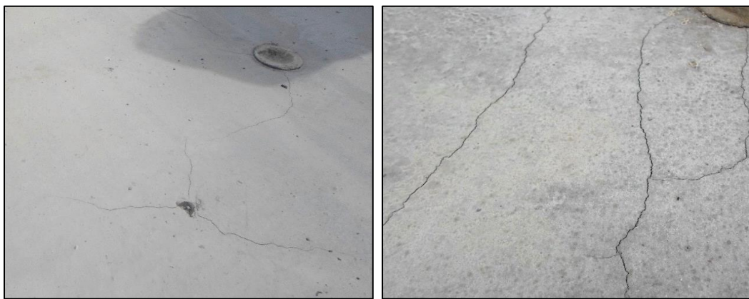
Figura N° 56 GC2 incremento de las fisuras en cantidad y dimensión.
