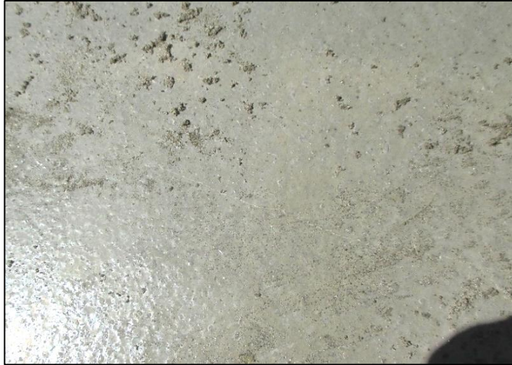
Figura N° 72 GE pliegue identificado en el fraguado inicial.
