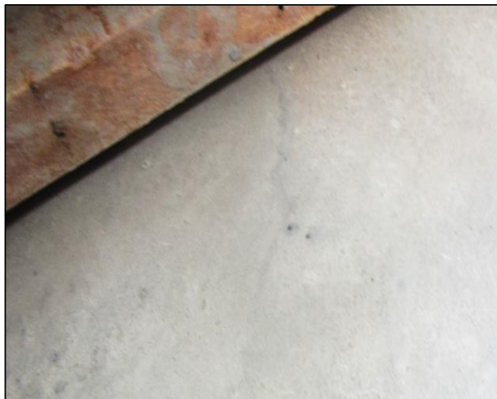
Figura N° 45 GC1 fisuras en el mortero en estado fresco.
