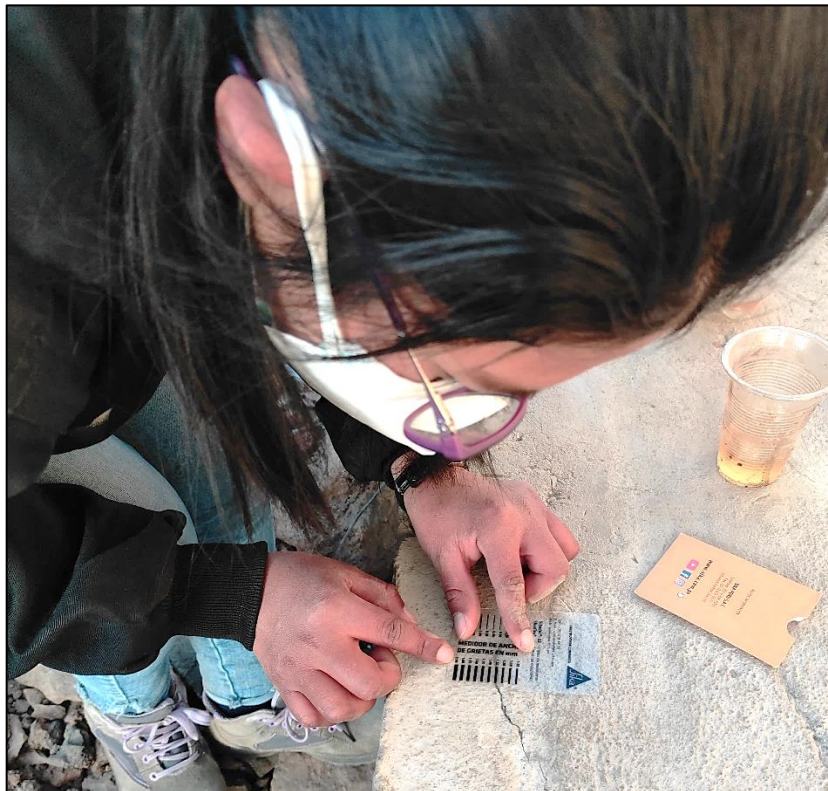
Foto 16 – GC identificación y medición de fisuras en el estado endurecido.
