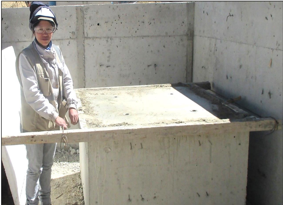
Foto 18 - GE presentación del producto final sin presencia de fisuración
