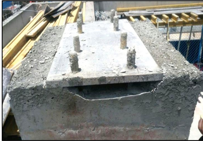
Figura N° 2 Contracción del concreto bajo placa de fijación.
