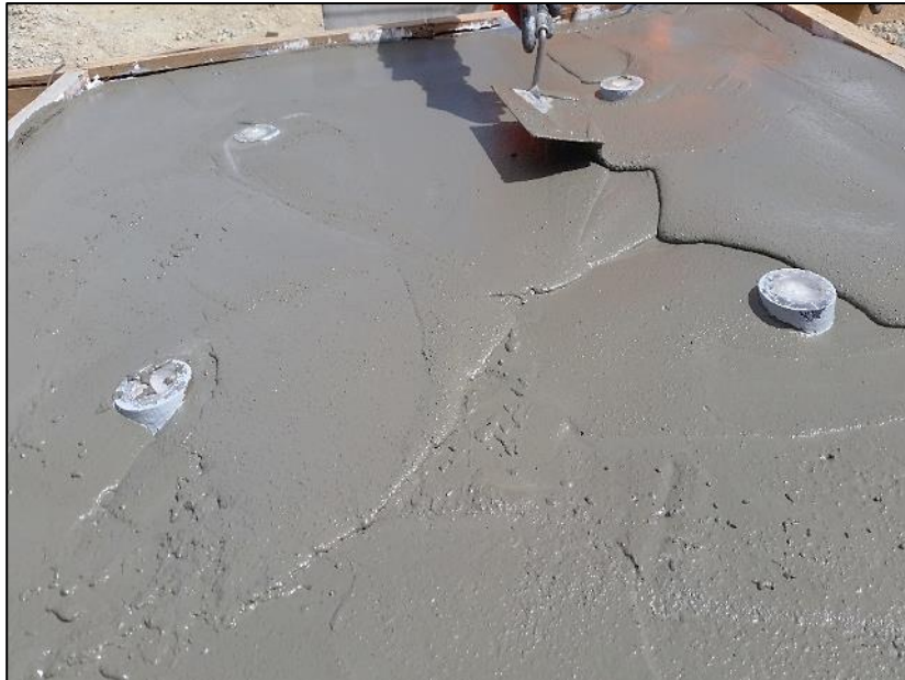
Figura N° 37 Mortero vaciado sin autocompactarse.
