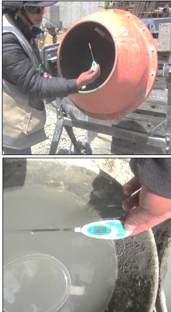
Figura N° 33 Registro de temperaturas.
