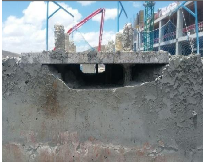
Figura N° 1 Inadecuado uso de concreto convencional debajo de placas de nivelación.
