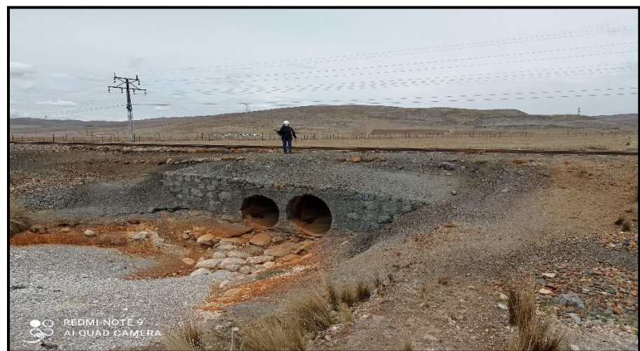
Figura 11. Imagen de la generación de lixiviado por las alcantarillas en shelby
