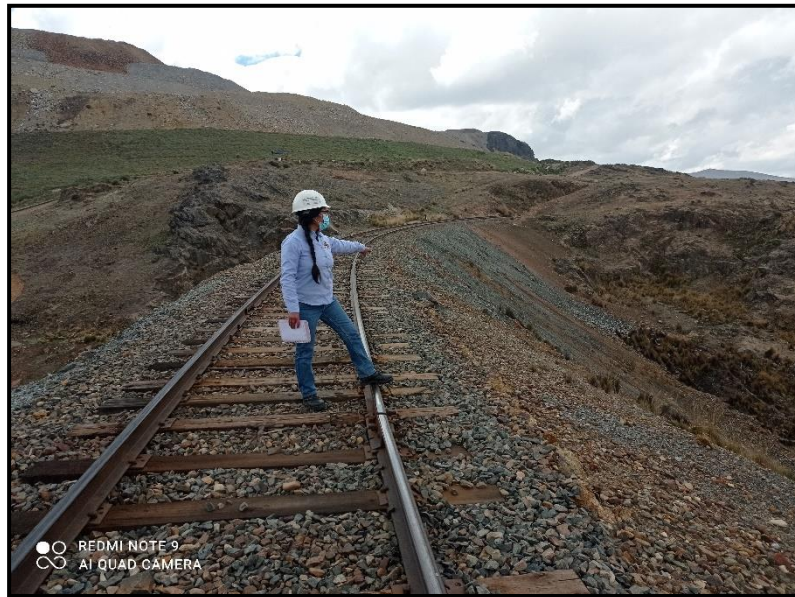
Figura 3. Imagen de la Vías férrea anclado en los durmientes
