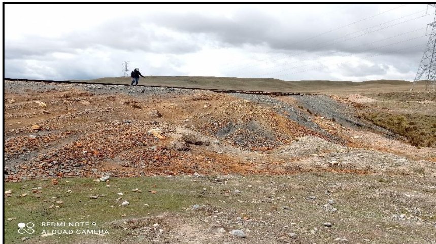
Figura 5. Imagen del talud formado con presencia de material piritoso en las alturas de la población de Quiulacocha
