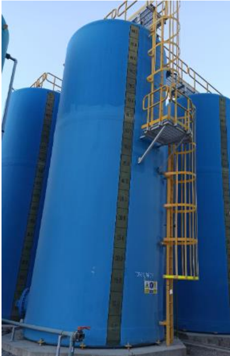
Ilustración 19.- Tanques de almacenamiento
