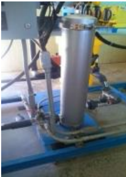
Ilustración 10.- Filtro pulidor para micras de 20 pulgadas de altura.
