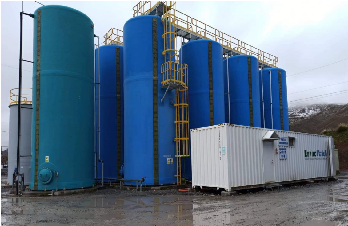
Ilustración 21.- Panorama de la Planta de Tratamiento de Agua Potable - Ósmosis Inversa
