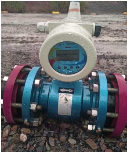
Ilustración 5.- Caudalímetro al ingreso salida de la planta de ósmosis inversa
