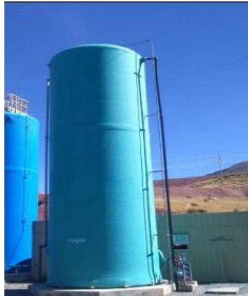
Ilustración 6.- Tanque de almacenamiento de agua cruda.
