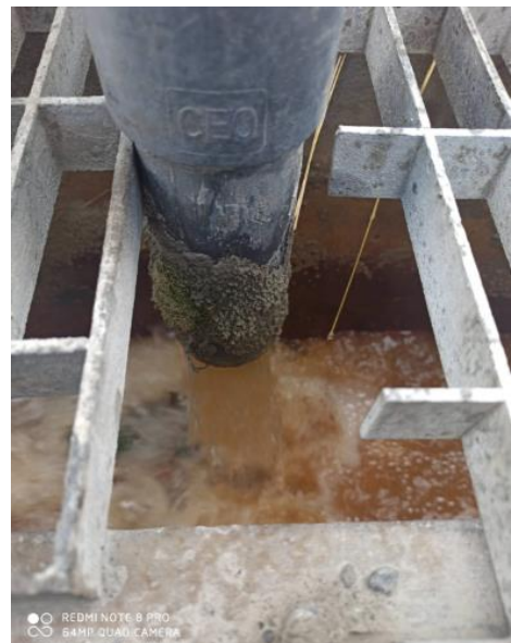
Ilustración 7.- Retro lavado del filtro multimedia.
