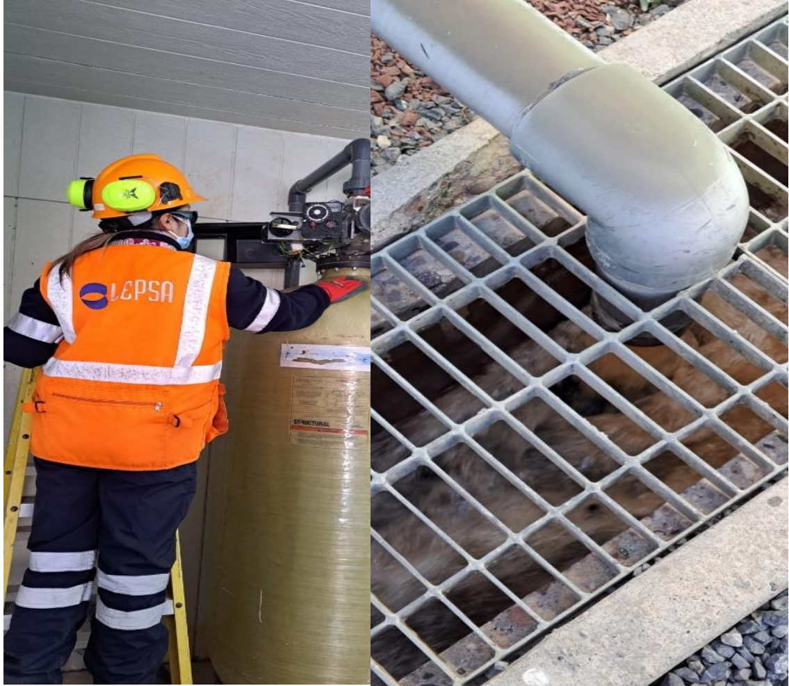
Ilustración 26.- Retro lavado de Filtros Multimedia - Planta de Ósmosis Inversa
