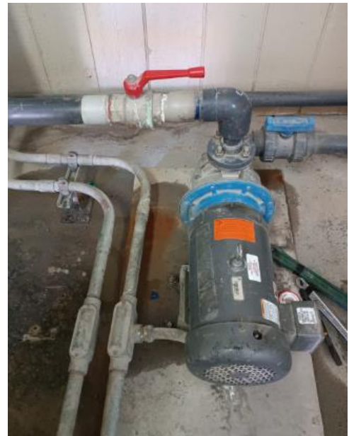
Ilustración 9.- Bomba Centrífuga de 2.5 HP
