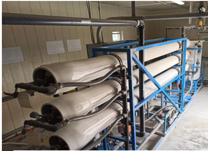
Ilustración 15.- Housing de las membranas de Ósmosis Inversa.
