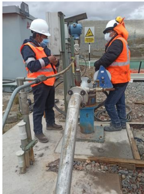
Ilustración 4.- Captación y bombeo de la RW-2.
