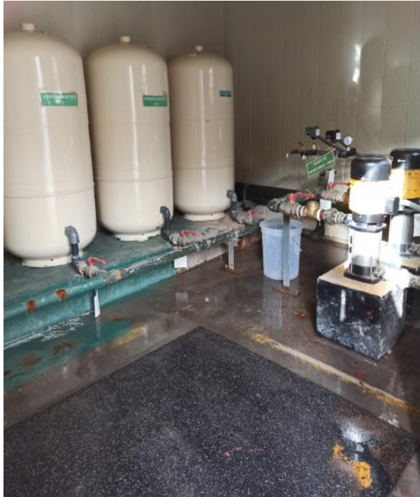
Ilustración 18.- Tanques Hidroneumáticos - Caseta de bombeo de Ósmosis Inversa.
