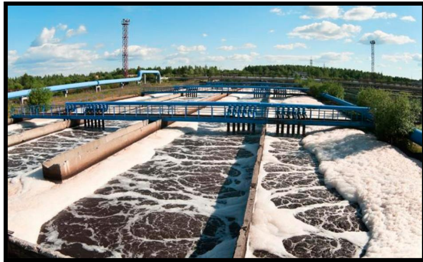
Figura N° 08. Tratamiento biológico de aguas residuales.
