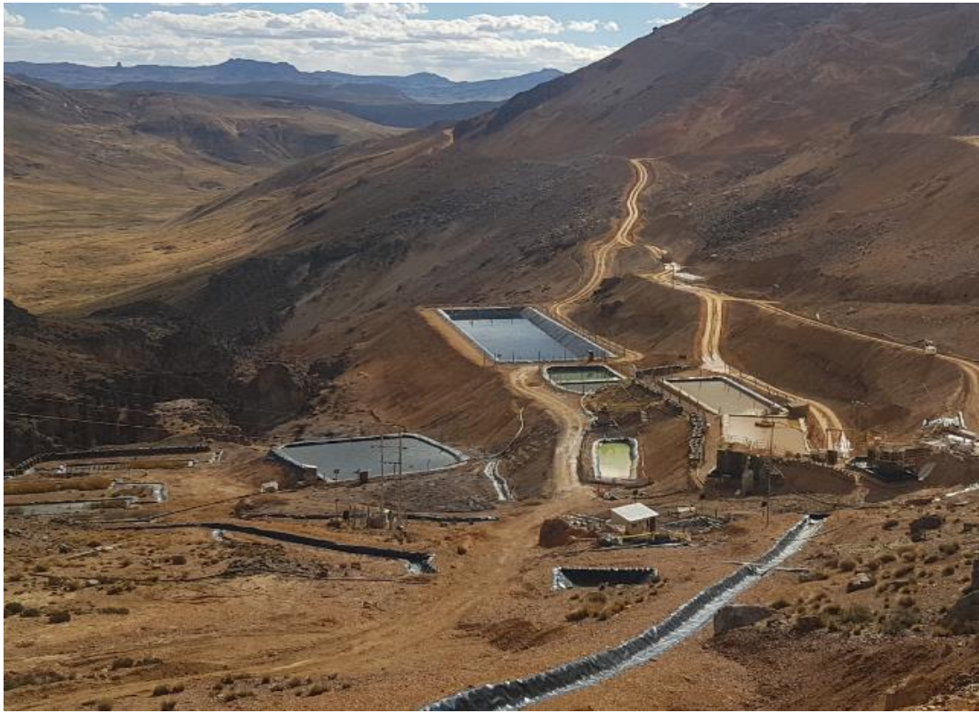
Imagen N° 03: Planta de Tratamiento de Aguas Ácidas
