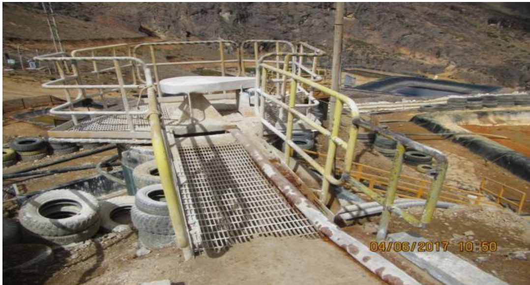
Imagen 7: Se observa un tanque de preparación de solución (floculante), el mismo que en su contorno perimetral posee una canaleta de geomembrana la cual tiene el fin de contener cualquier posible derrame del tanque.
