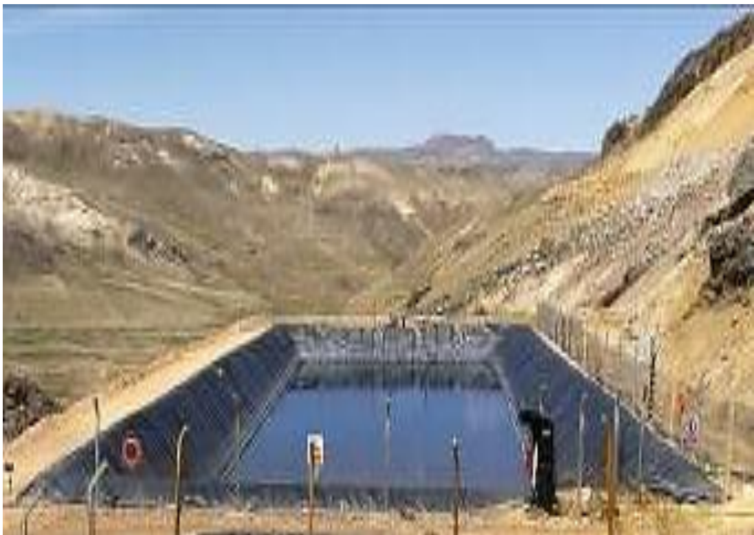
Imagen 10: Se observa poza de homogenización u sedimentación, poza de colección de todos los flujos de agua a tratar. Capacidad de 6000 m3
