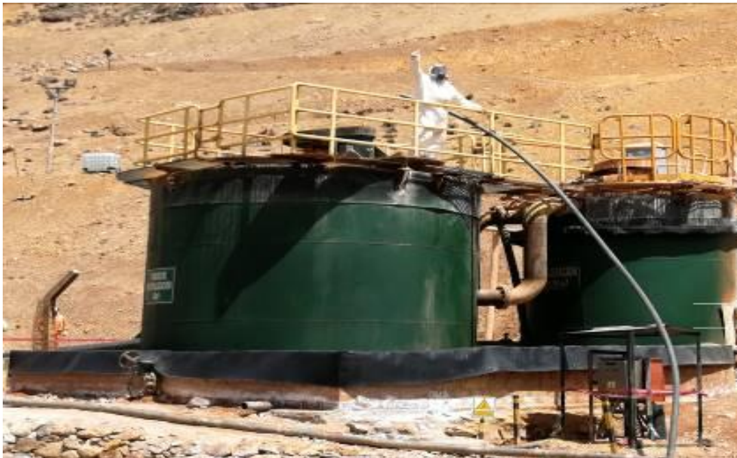
Imagen 8: Se observa los 02 tanques de neutralización de 20 y 40 m 3 de capacidad cada uno, los mismos que realizan la neutralización del agua ácida.
