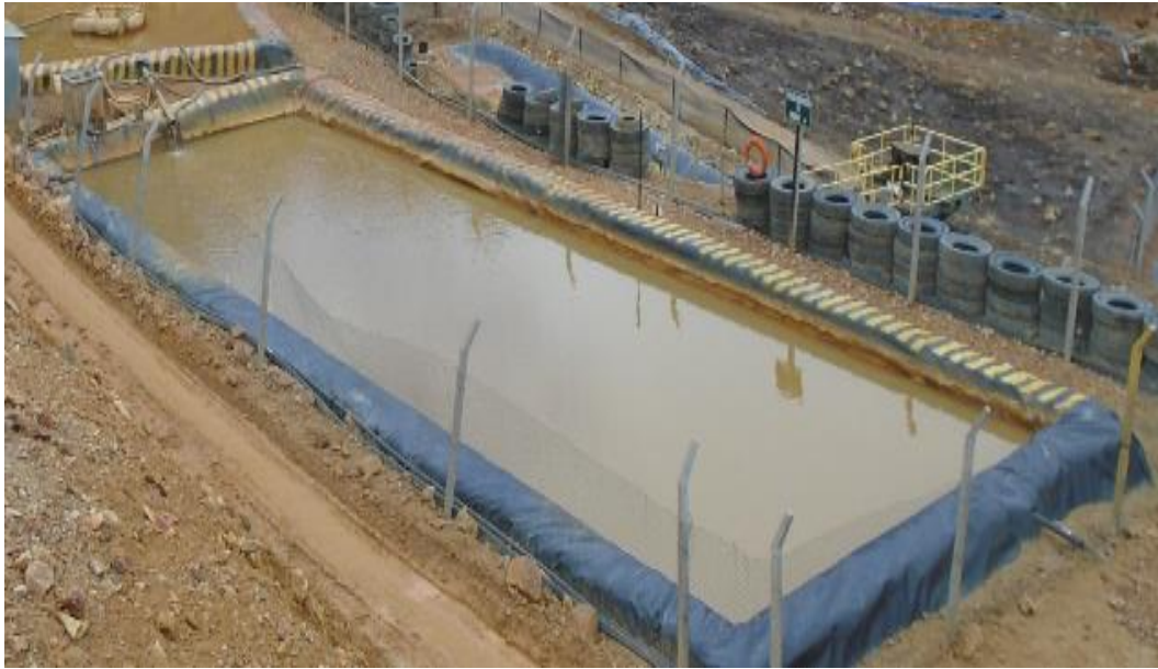
Imagen 13: Poza de sedimentación N° 4, poza donde se recepciona las aguas tratadas para la primera etapa. Capacidad de 972m 3
