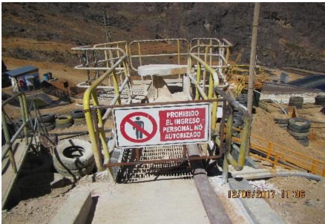
Imagen 6: Se observa un tanque de preparación de solución (lechada de cal 20 M3), el mismo que en su contorno perimetral posee una canaleta de geomembrana la cual tiene el fin de contener cualquier posible derrame del tanque.
