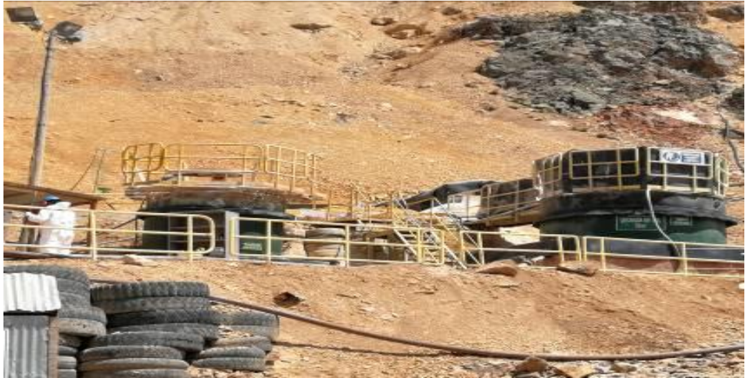
Imagen 9: Vista panorámica del 3er Tanque de Neutralización de agua acida, el mismo que posee su plataforma cerrada de contingencia ante posibles derrames.
