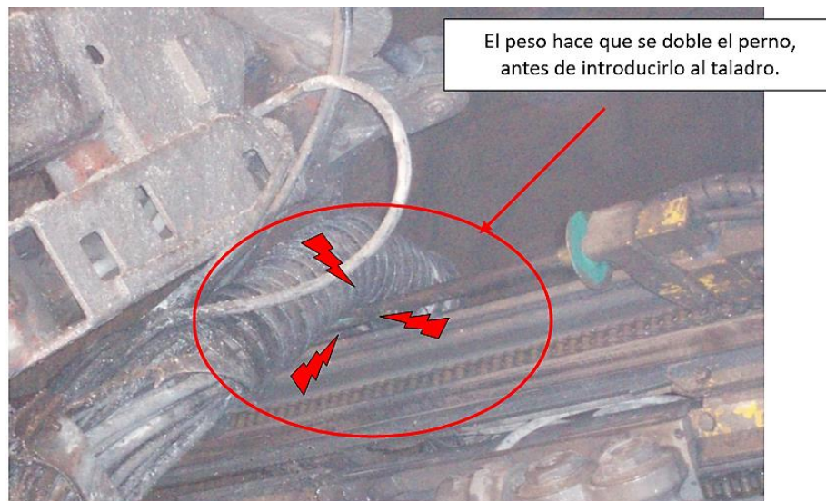
Figura N° 64: El peso de la manguera hace que se doble el perno.
