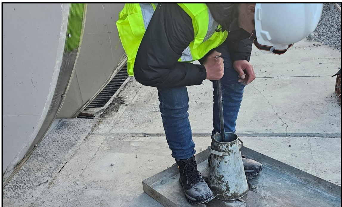
Fotografía 30.- Chuseada para la prueba con el cono de abrams para ver el asentamiento.
