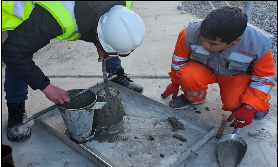
Fotografía 31.- Medición de la prueba con el cono de abrams para ver el asentamiento.
