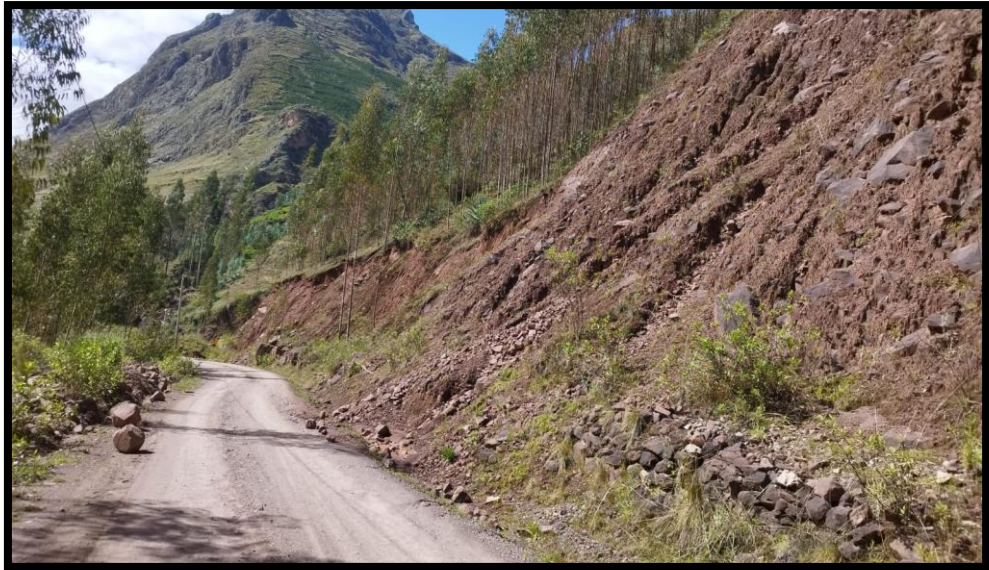
Figura 1. Exploración de campo donde se puede apreciar la presencia de deslizamientos.
