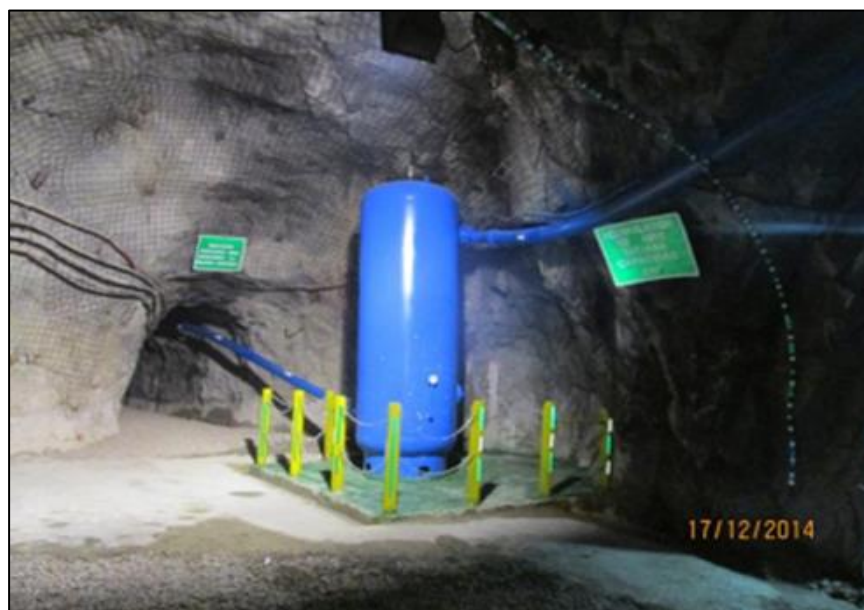
Ilustración 21. Pulmón de Aire Interior Mina NV 1020
