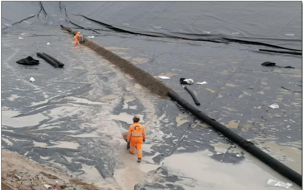
Ilustración 21: Rellenado con material arena en la instalación de tubería del sistema de drenaje.
