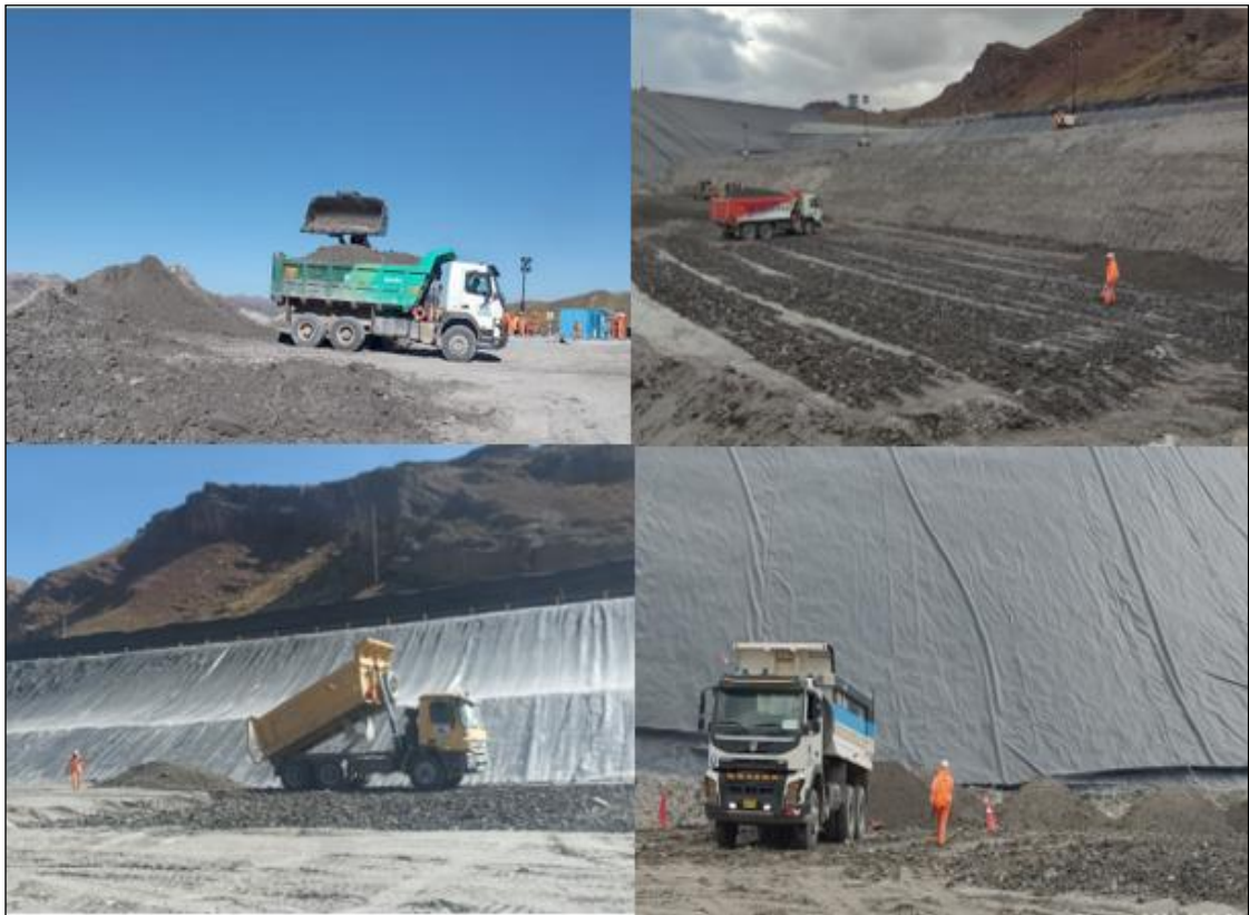
Ilustración 34: Carguío, transporte y descarguío de material mezclado con equipo volquete de 15m 3 .
