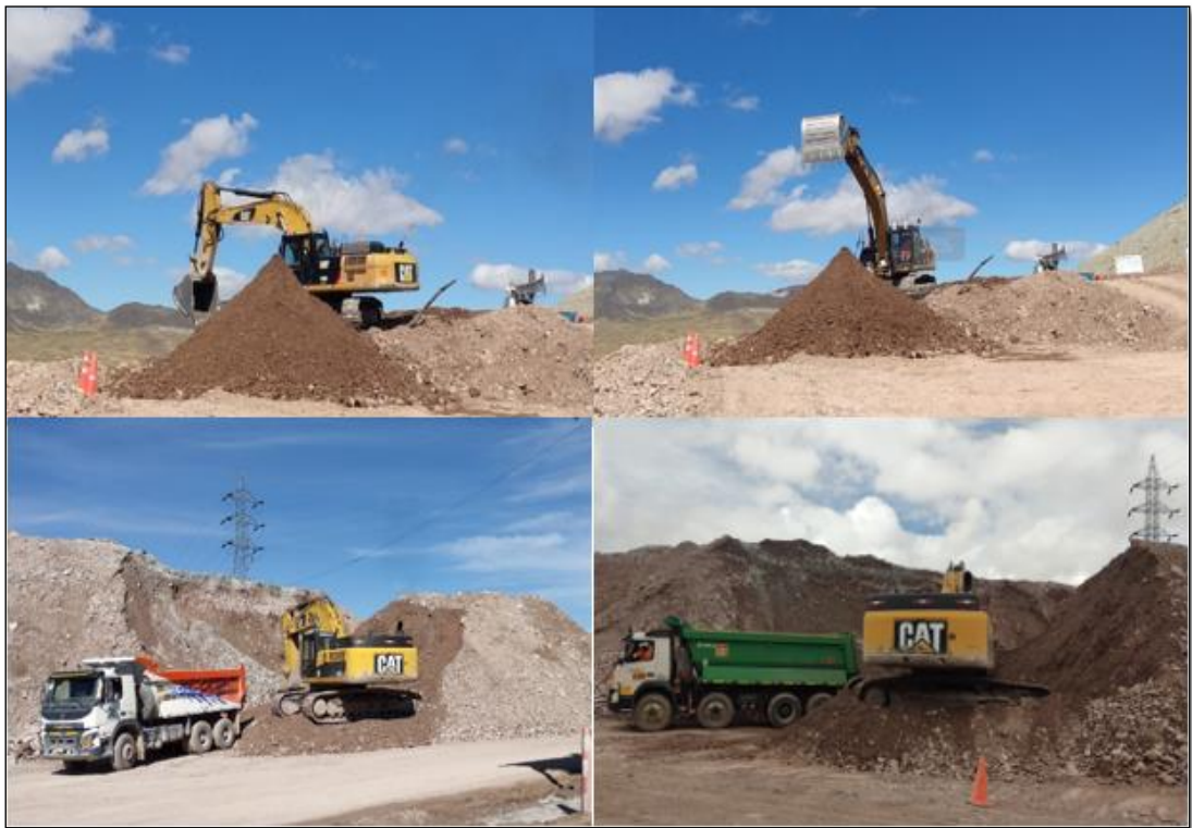
Ilustración 30: Repaleo y venteado del material de préstamo o desmonte con equipo excavadora.
