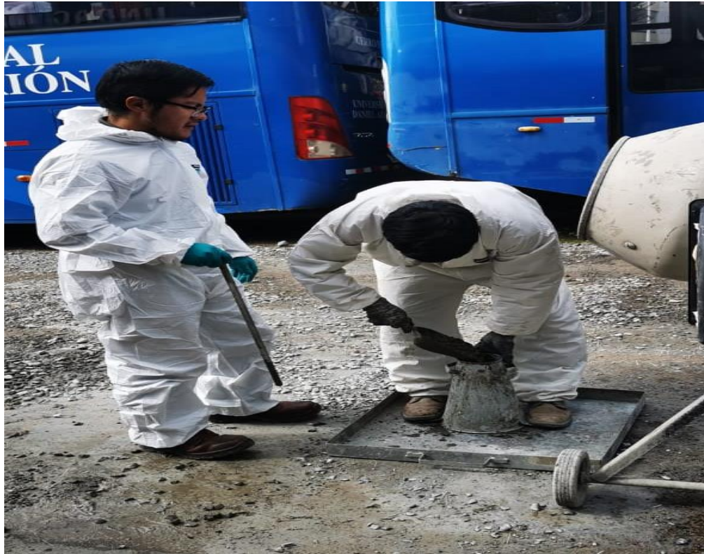
Fotografía 15. Verificación del SLUMP de concreto con el método de Cono de Abrams, verificándose que se tiene una medida máxima de 3''- 4'''.
