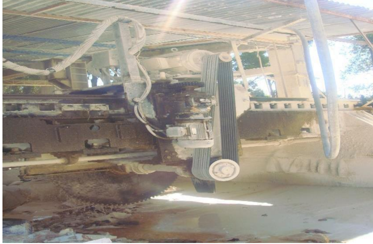
Foto 5. Máquina de corte hidráulico con riesgo eléctrico
