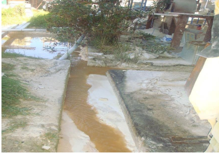
Foto 11. Impacto ambiental, Riesgo para el personal.
