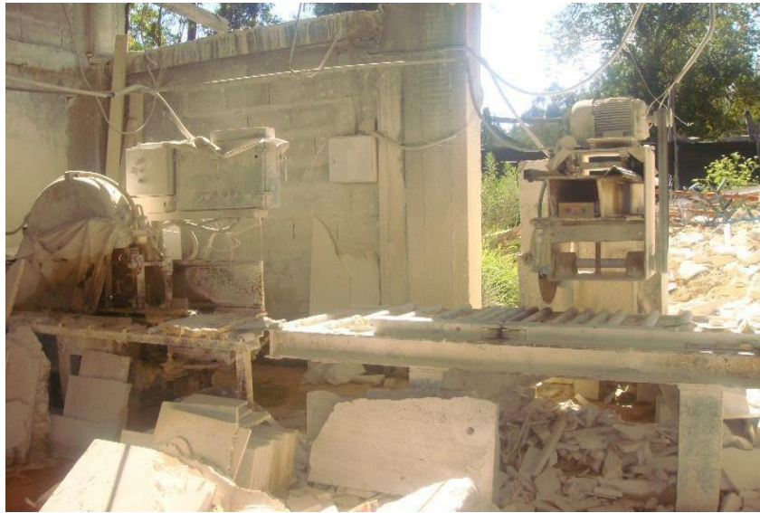
Foto 8. Desorden en la máquina de corte hidráulico
