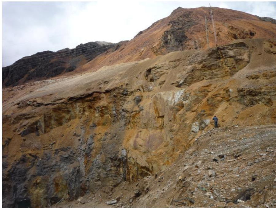
FOTO N° 18.- Vista mirando al Oeste, se observa la alteración argílica a partir de fracturas y fallamientos del sistema estructural E-W, en la zona denominada Tajo Greta. UTM: 309186 E, 8843671 N.
