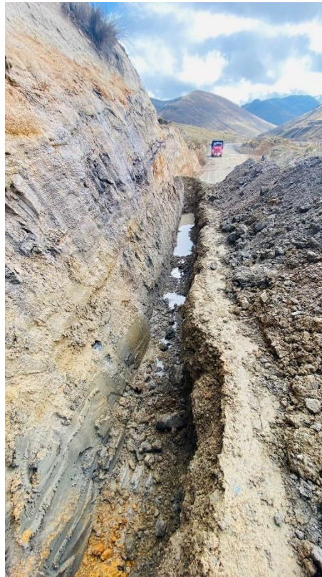
Ilustración 6: Presencia de agua en la excavación de la zanja (Fuente: Propio)
