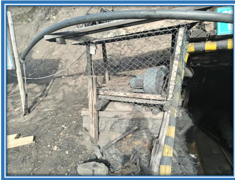
Ventilador eléctrico de la labor Oviedo
