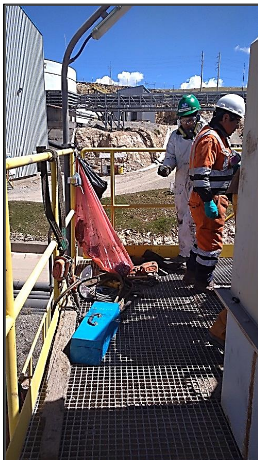
FOTO N° 4. Segregación en los puntos de trabajo
