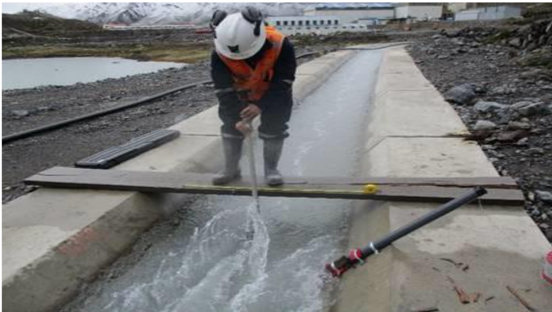
Figura 10 Aforos junto con la instalación de punto de medición de nivel de agua TP-2 a
