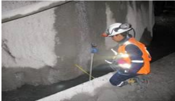
Figura 9 Mediciones de caudal en las cunetas llegando a las pozas de sedimentación
