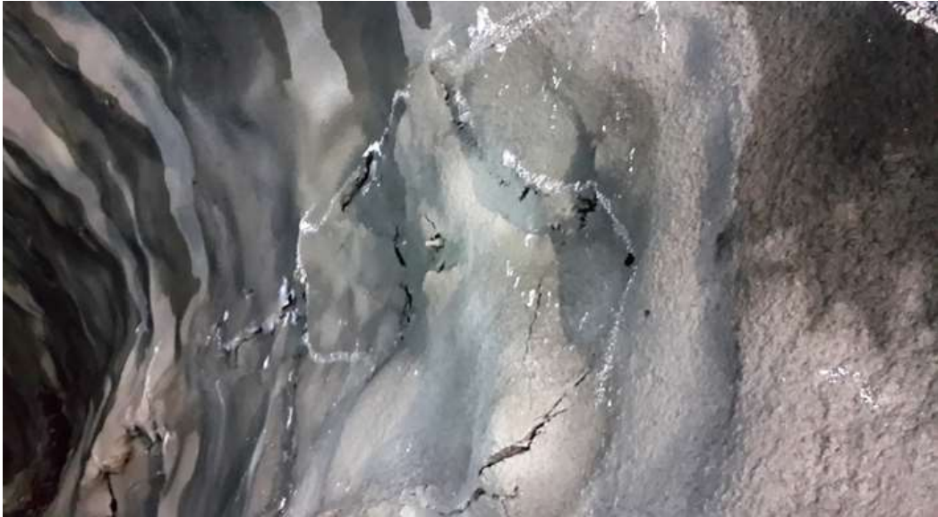
Foto 3 Producto de las deformaciones hastial izquierdo fisurado
