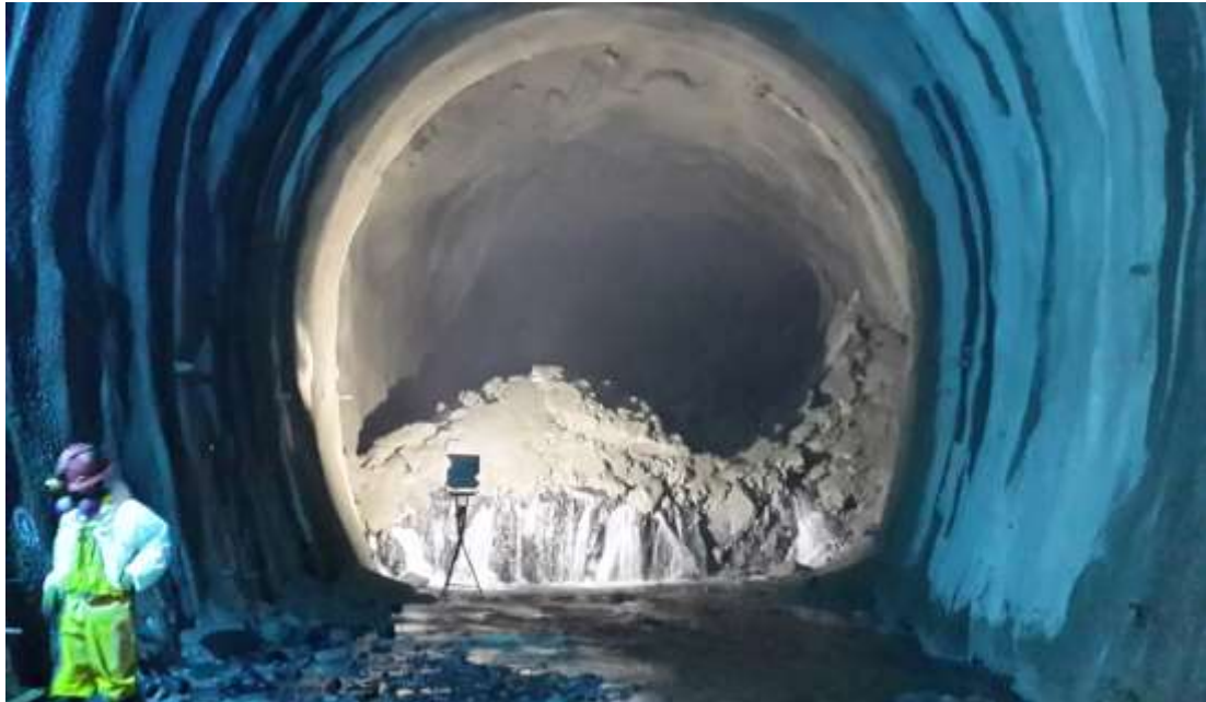
Foto 5 Presencia de agua en el Frente 04 en la Ventana 02 del Túnel de Aduccion.
