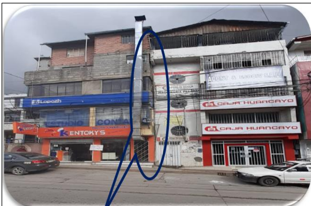
Figura 9. Imagen de dos edificios con falla por junta sísmica
