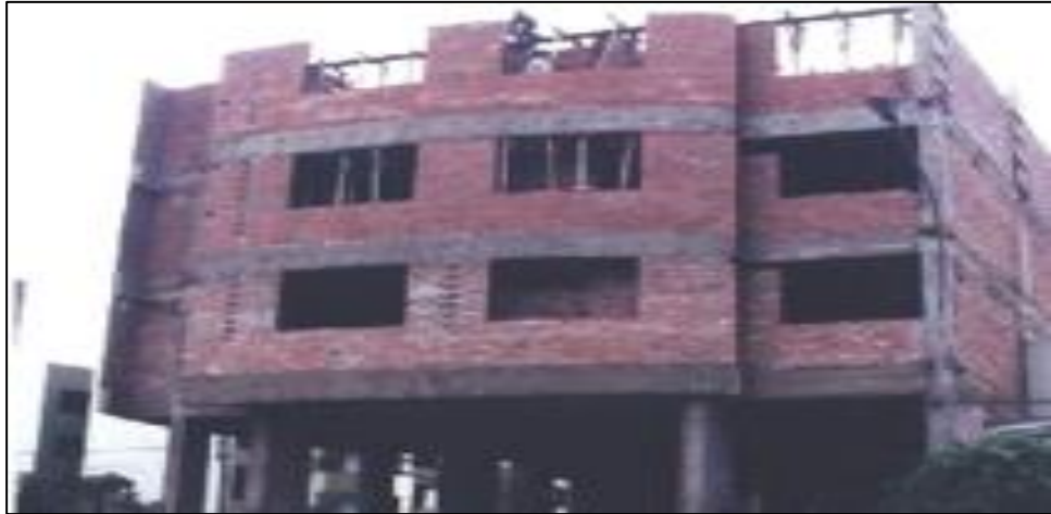
Figura 8. Imagen de una edificación con falla por piso blando
